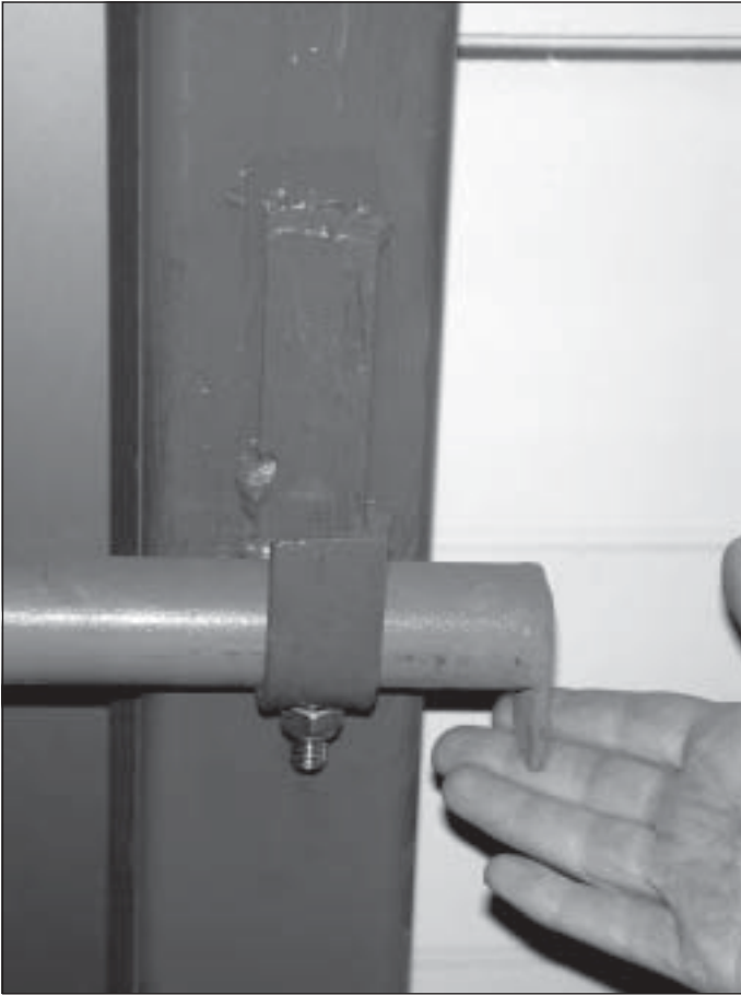
Kuva 3. Tapaturman jälkeen rakennettu turvakaiteen kiinnitystapa (ruuviliitos kai-teen ja kannattimen läpi).
