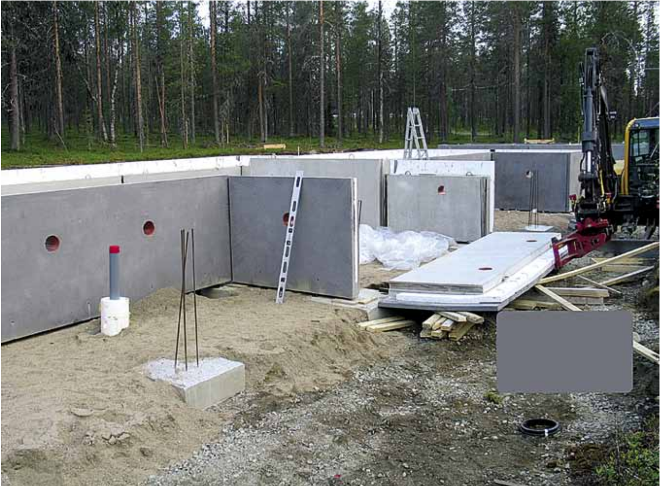
Kuva 3. Yleiskuva tapaturmapaikasta. Kaatunutta elementtiä on pelastustoimien yhteydessä nostettu työkoneella ja tuettu lankuilla.
