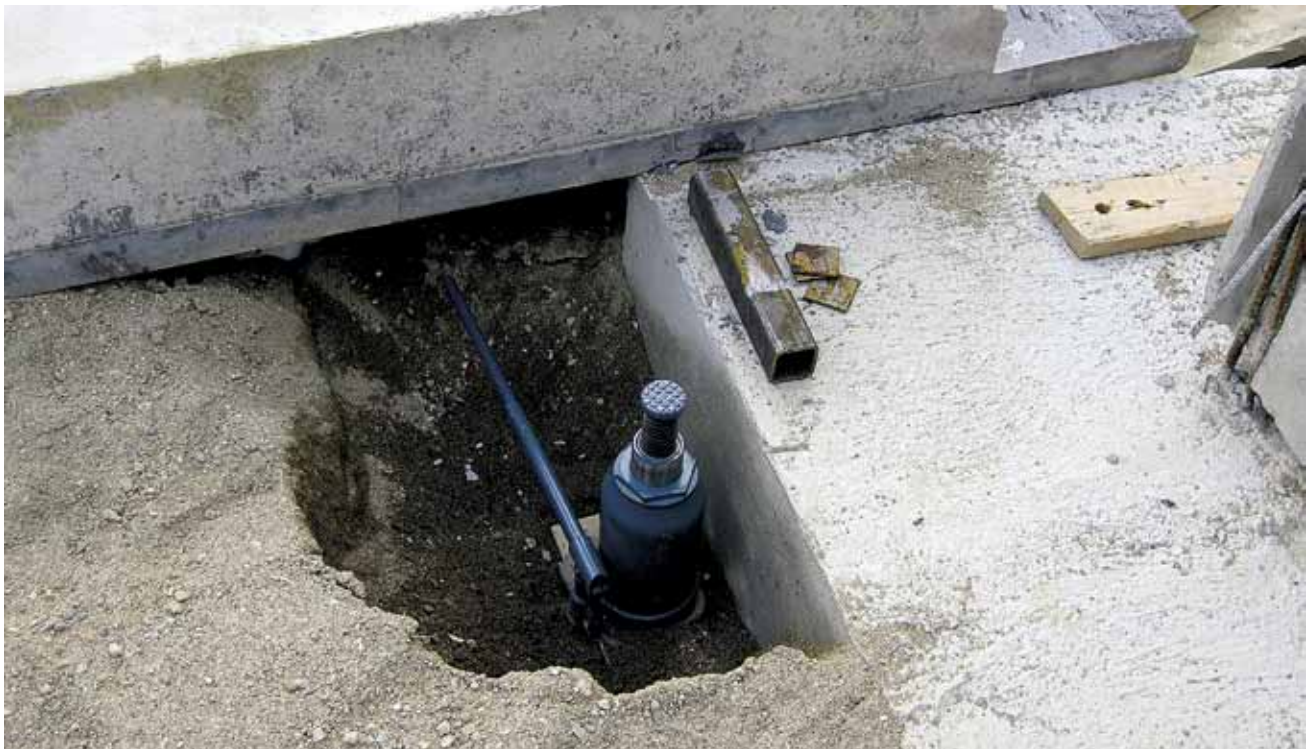
Kuva 2. Antura, sokkelielementti, palikan päälle asetettu nestetunkki, hieman elementin paksuutta lyhyempi putkipalkin pätkä ja korotuspaloja tapaturman jälkeen.
