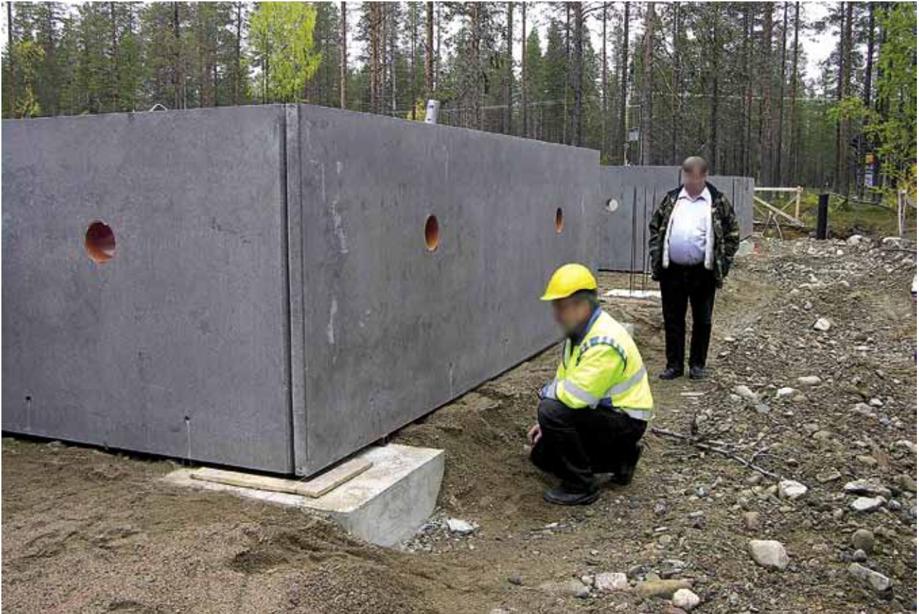
Kuva 1. Lavastettu kuva NN:n paikasta polvillaan elementin ulkokehällä. Kuvan rakennuskohde tai henkilöt eivät liity tapaturmaan. Kuvan sokkelielementti on korkeampi kuin tapaturmassa kaatunut elementti.
