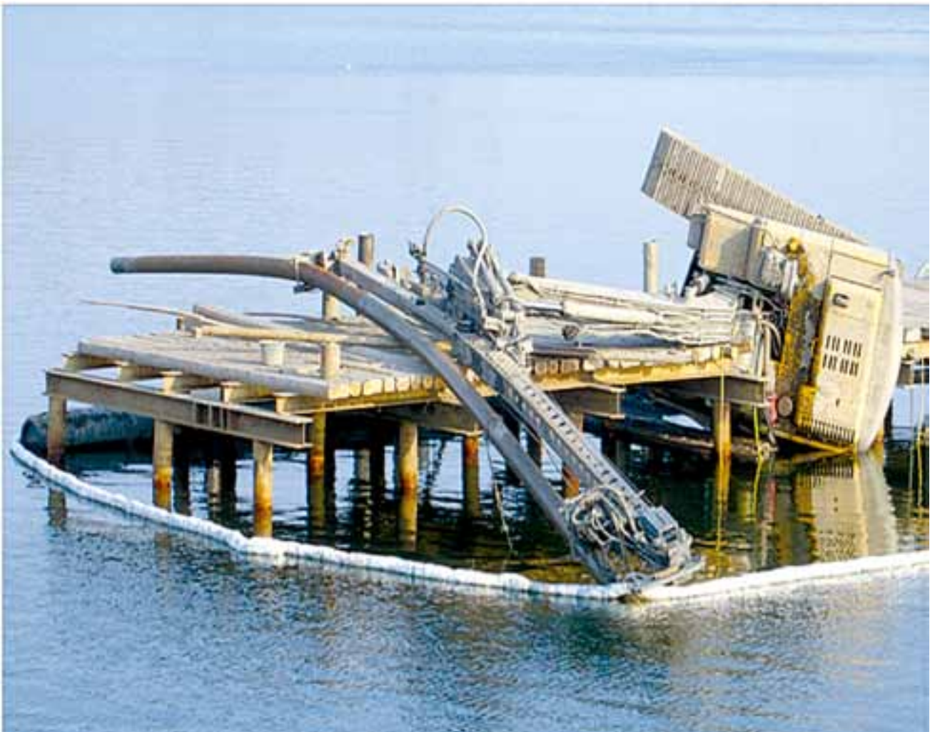
Kuva 3. Paalutuskone kaatui osittain romahtaneen työsillan seurauksena. NN jäi puristuksiin työsillan kansirakenteen ja paalutuskoneen puomin väliin.
