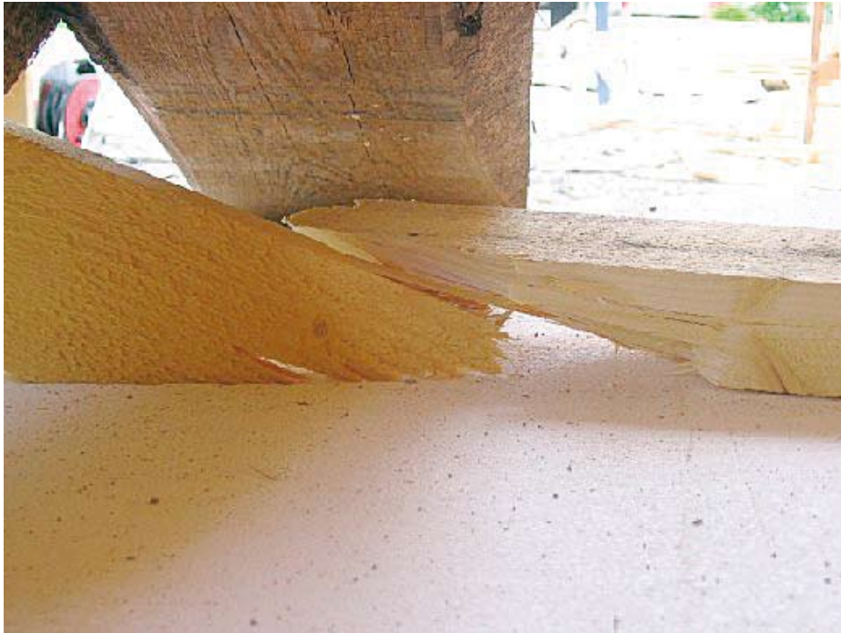
Kuva 3. Kuvassa on katkenneen 2. poikki puun katkeamiskohta ja sen päälle jäänyt telinelankku. (Kuva otettu periaatekuvan 2 suuntaan)
