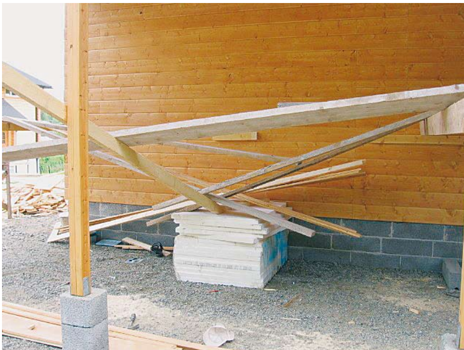
Kuva 4. Romahtanut telineen kohta kuvattuna periaatekuvan 1 suunnasta. Kuvassa näkyy pylvääseen kiinnitettyä katkennut 2. poikkipuuta.
