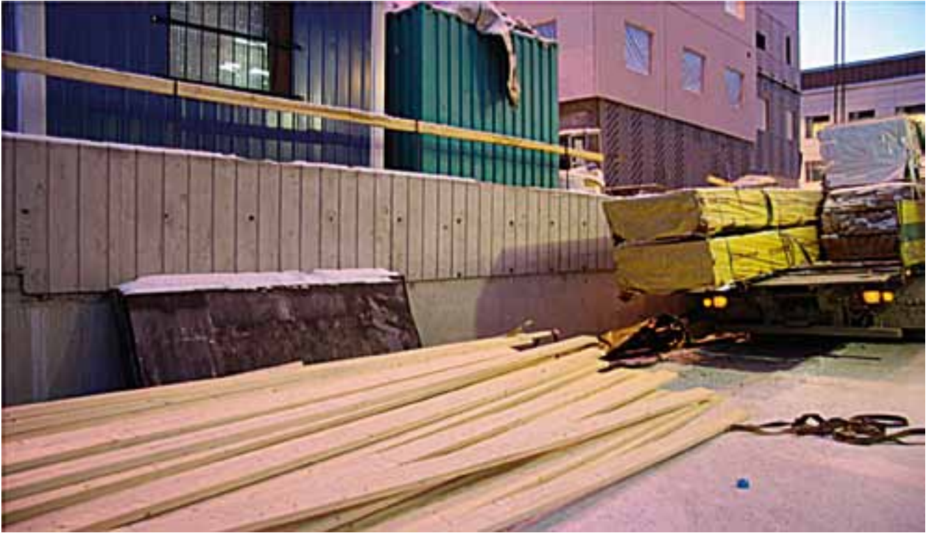
Kuva 6. Kuorman purkauspaikka oli kallellaan betoniseinämän suuntaan.
