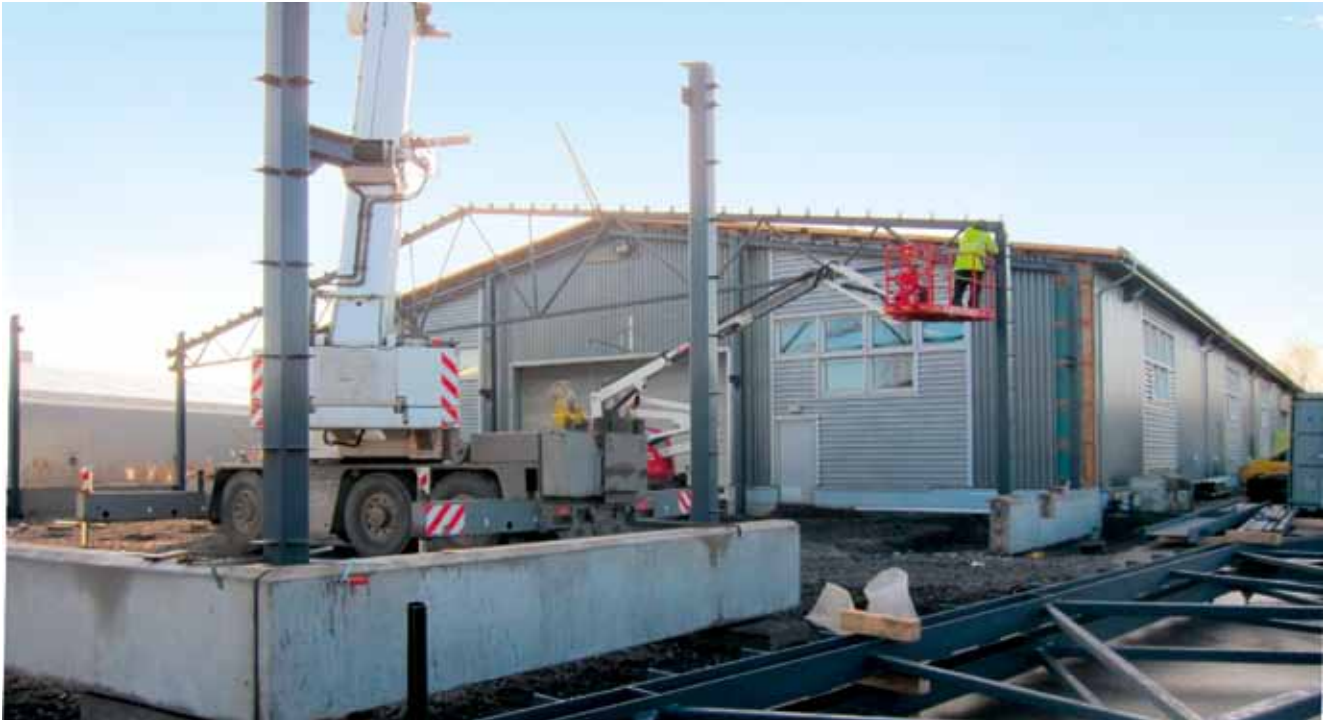
Kuva 7. Rakennustyömaan nostokoneille tulee suorittaa päivittäin toimintakokeilu.
