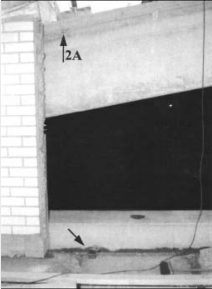
Kuva 5. Kaatuneen elementin asentamisessa oli ongelmia. Elementin mikään hitsaustartunta ei sopinut kohdalleen. Elementtiasentaja sai vain kaksi ylimmäistä hitsaustartuntaa (kuvassa nuolen kohdalla toinen hitsaustartunta) kohdalleen vääntämällä. Muita tartuntoja ei elementtiasentaja ryhtynyt hitsaamaan, koska ne eivät olleet kohdallaan.
