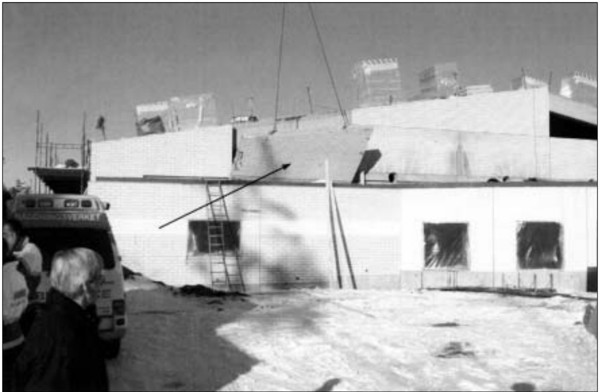
Kuva 1. Kauppakiinteistön lisärakennustyömaalla oli käynnissä elementtien asennustyö. Työmaalla asennettiin betonisia seinäelementtejä rakennuksen päättyyn. Aamupäivällä asennettu seinäelementti, kaatui yllättäen iltapäivällä. Elementin alle jäänyt muissa työtehtävissä ollut NN (nuoli) menehtyi saamiinsa vammoihin.
