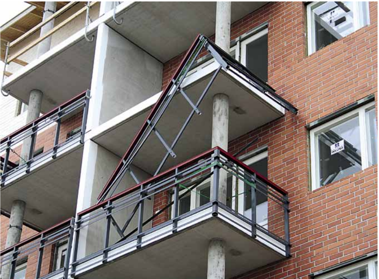
Kuva 3. Tapaturman yhteydessä sidontaliinan varaan pudonnut kaide-elementti.
