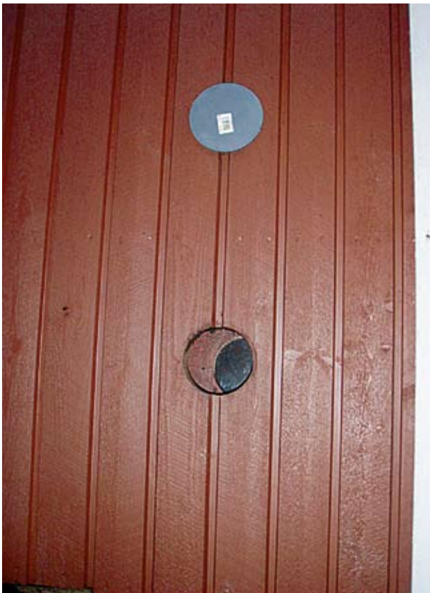
Kuva 3. Siilorakennuksen seinässä olevat pelletin määrän tarkistusaukot.
