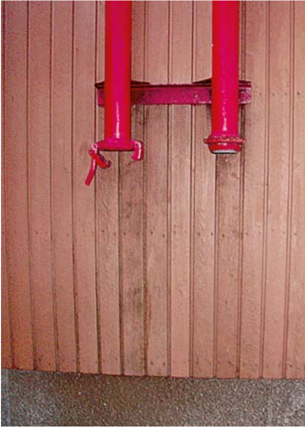
Kuva 4. Siilorakennuksen seinään asennettu pelletin syöttöputki ja täyttöilman poistumisputki.
