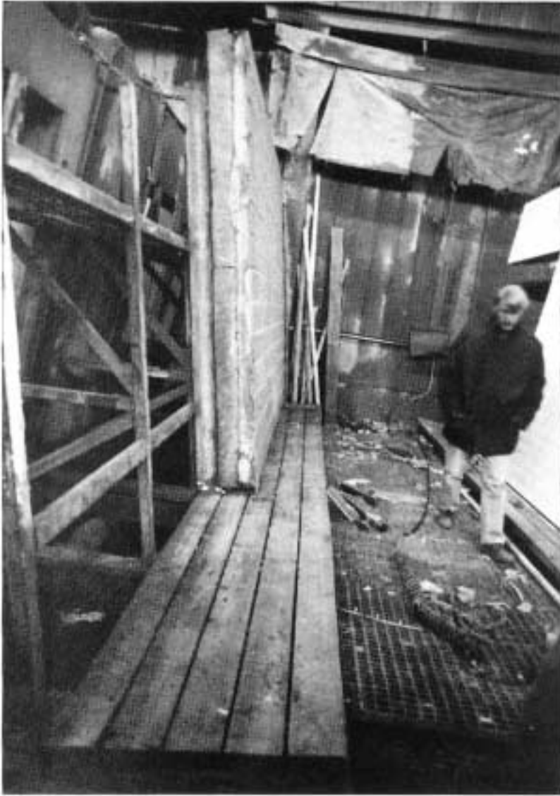
Kuva 1. Teline, jonka ritilätasolla kaatunut elementti oli.
