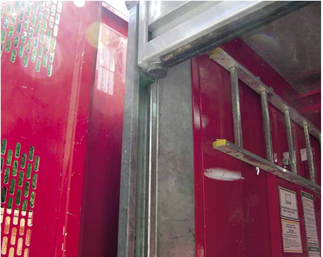
Kuva 5. Lähikuva kuvan 4 hissien korin portin mekaniikasta. Kuvasta on poistettu tunnisteet, kuvan hissi tai työmaa eivät liity tapaturmaan.
