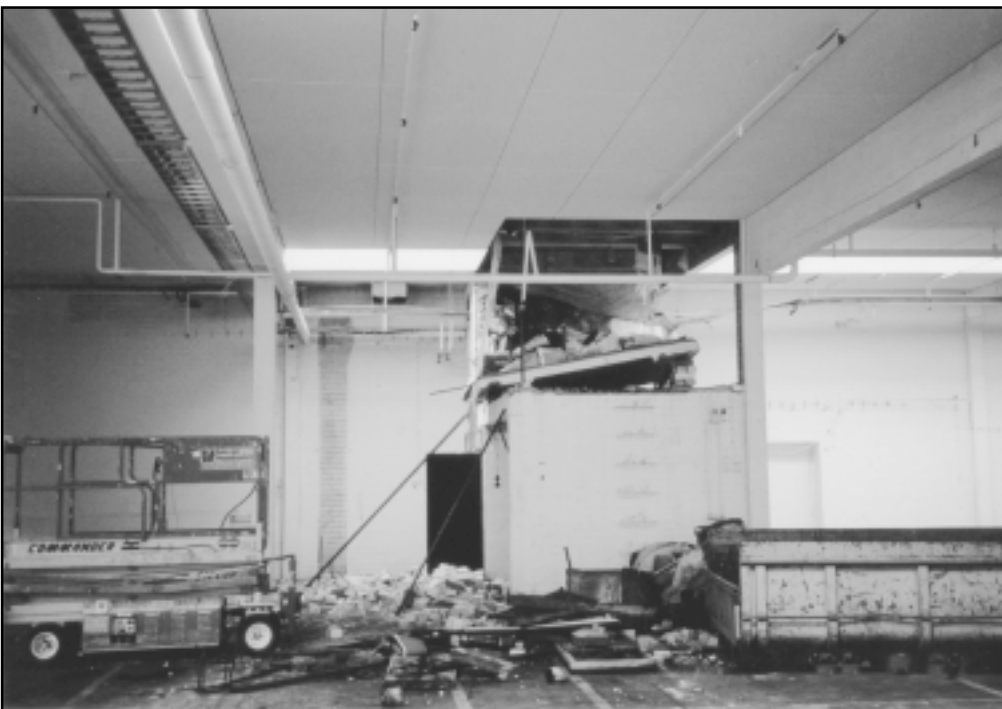
Kuva 2. Kun tiiliseinän viimeinen kulma purettiin, putosi kattolaatta äkisti alas. Purkutyössä ei käytetty henkilönostinta, vaikka se oli tuotu työmaalle purkutyötä varten.
