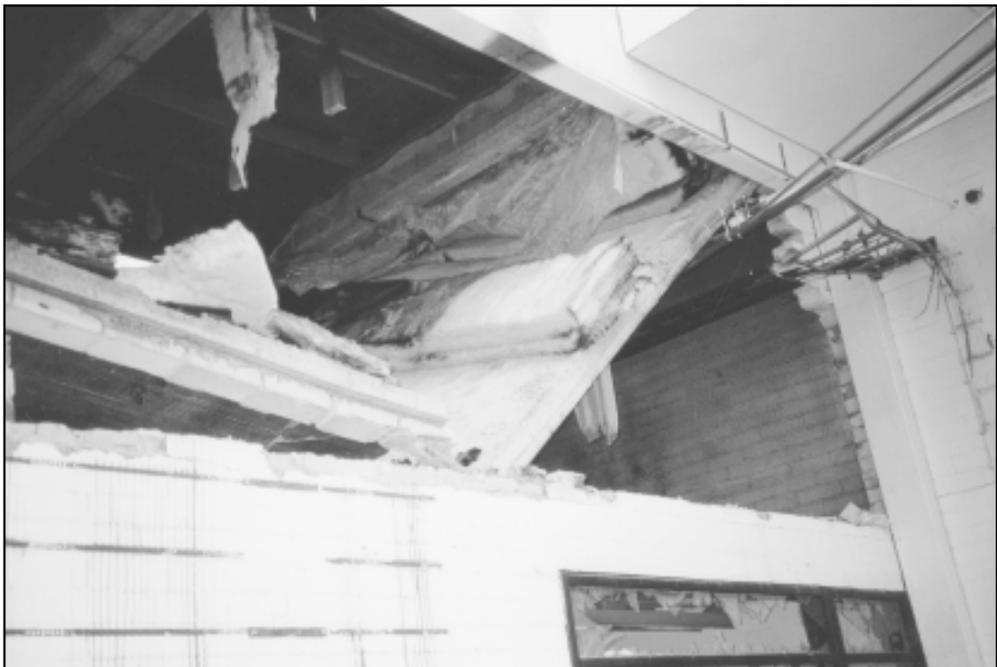
Kuva 4. SS ja TT jäivät myös kattolaatan alle, mutta eivät loukkaantuneet, koska laatta jäi toisesta päästään kannatukseen betoniterästen varaan.
