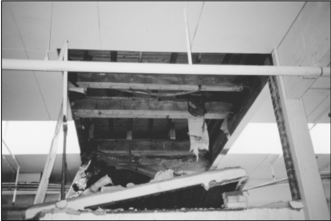
Kuva 3. NN jäi puristuksiin kattolaatan alle (puristuskohta merkitty kuvaan).
