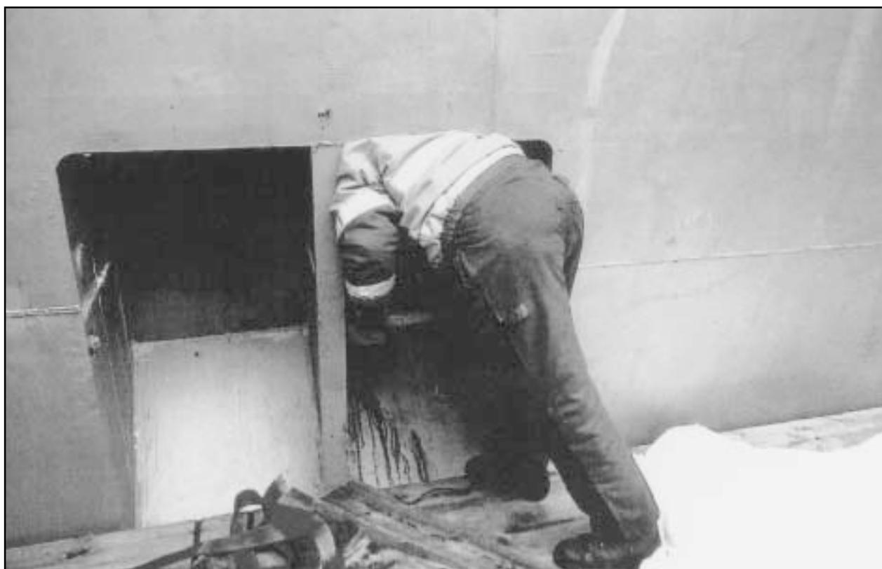
Kuva 5. KK näyttää kuinka NN yritti suojautua tuuletuskuiluun. Tästä huolimatta noin neljä lankkua iskeytyi NN:n selkään ja niskaan työntäen hänet kuilun perällä olleita tikkaita vasten.
