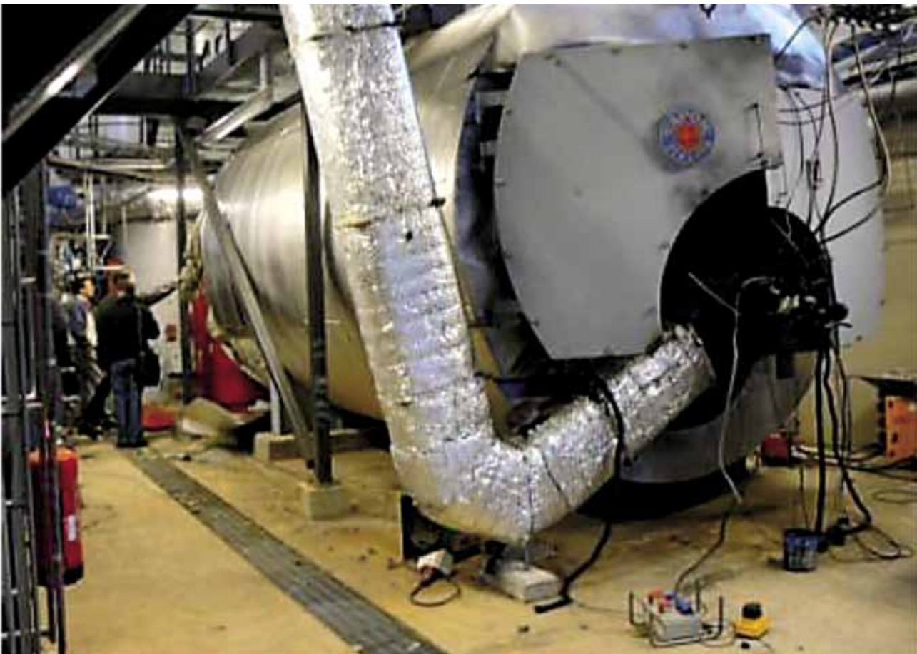
Kuva 2. Höyrykattila poltinpäädyn puolelta (kuva kopioitu Turvatekniikan keskuksen onnettomuustutkintaraportista 4006/06/2007).
