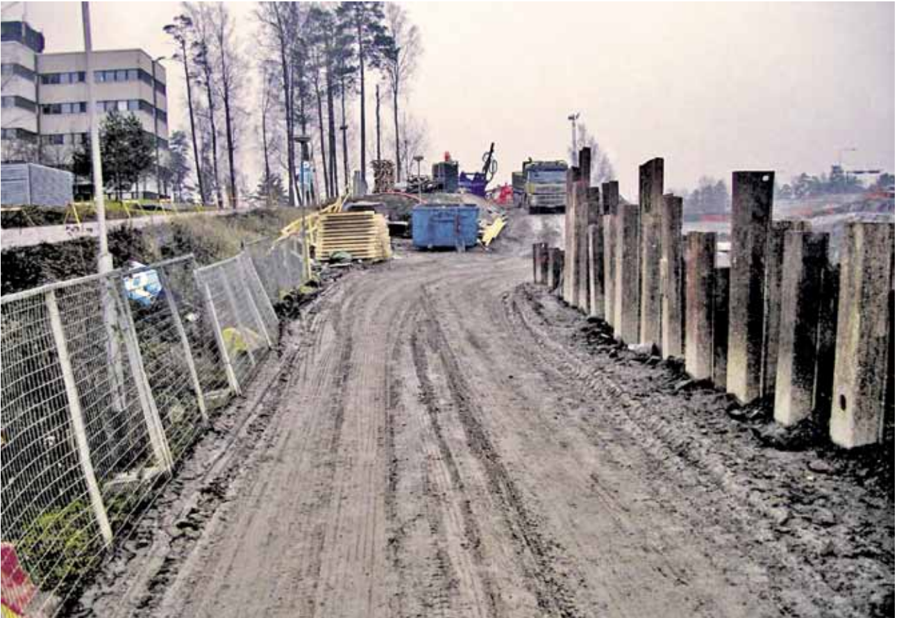
Kuva 1. Reitti, jonka kuorma-auto joutui peruuttamaan kuormaustapaikalle. Kuorma-auto on paikalla, jossa NN jäi sen alle. Kuvasta on poistettu henkilöt ja tunnisteet
