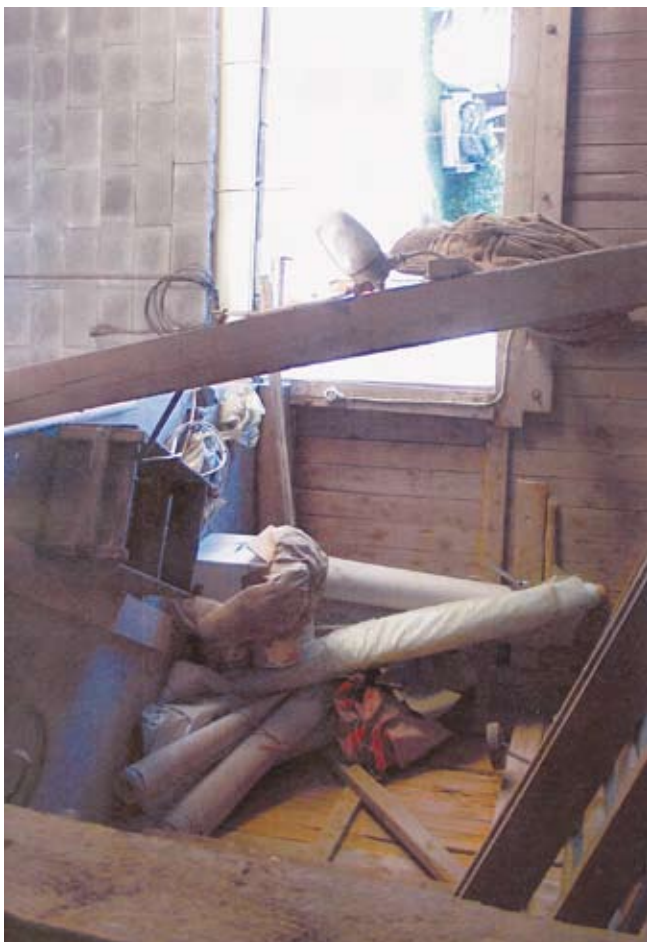
Kuva 3. Yläpohjan laatalle oli tapahtumahetkellä sekalaisia tavaroita, joihin NN on saattanut kompastua.
