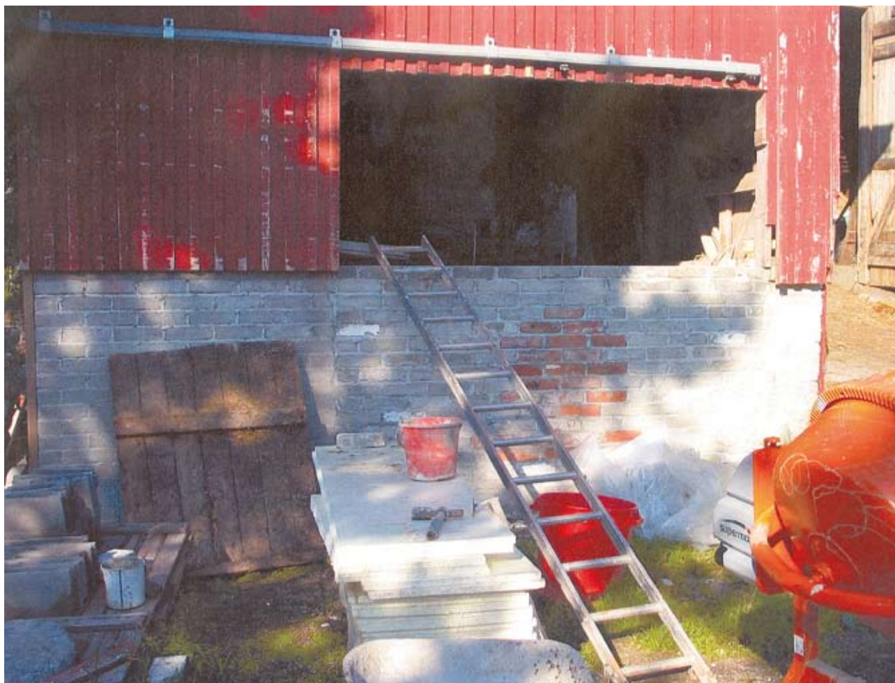
Kuva 1. Maatilalla muutettiin viljankuivaamon varastohuonetta navetan tankkihuoneeksi. Tapahtumahetkellä NN oli irrottamassa varaston liukuoven kiskoa, joka oli kiinnitetty läpipulttauksella navetan ulkoseinässä olleen oviaukon yläpuolelle.
