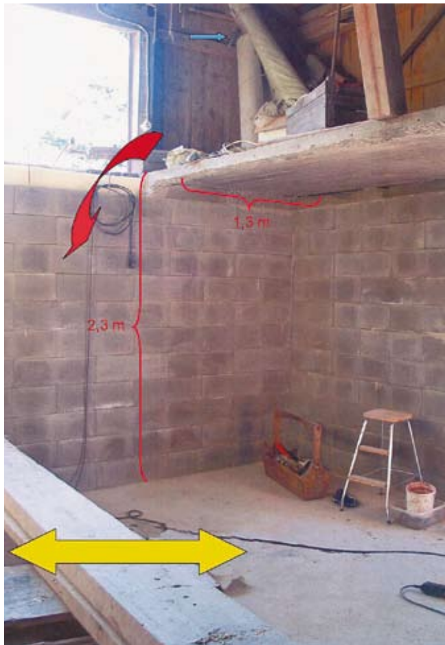
Kuva 2. NN käytti työtasonaan rakennuksen entistä yläpohjan laattaa, josta käsin hän ennätti irrottaa yhden pultin. Irrottaessaan toista pulttia hän putosi suojaamattomasta aukosta rakenteilla olevan tankkihuoneen betonilattialle. NN:n käyttämä jakovain jäi kiinni toiseen pulttiin (sininen nuoli). Keltainen nuoli osoittaa paikan, johon NN putosi.
