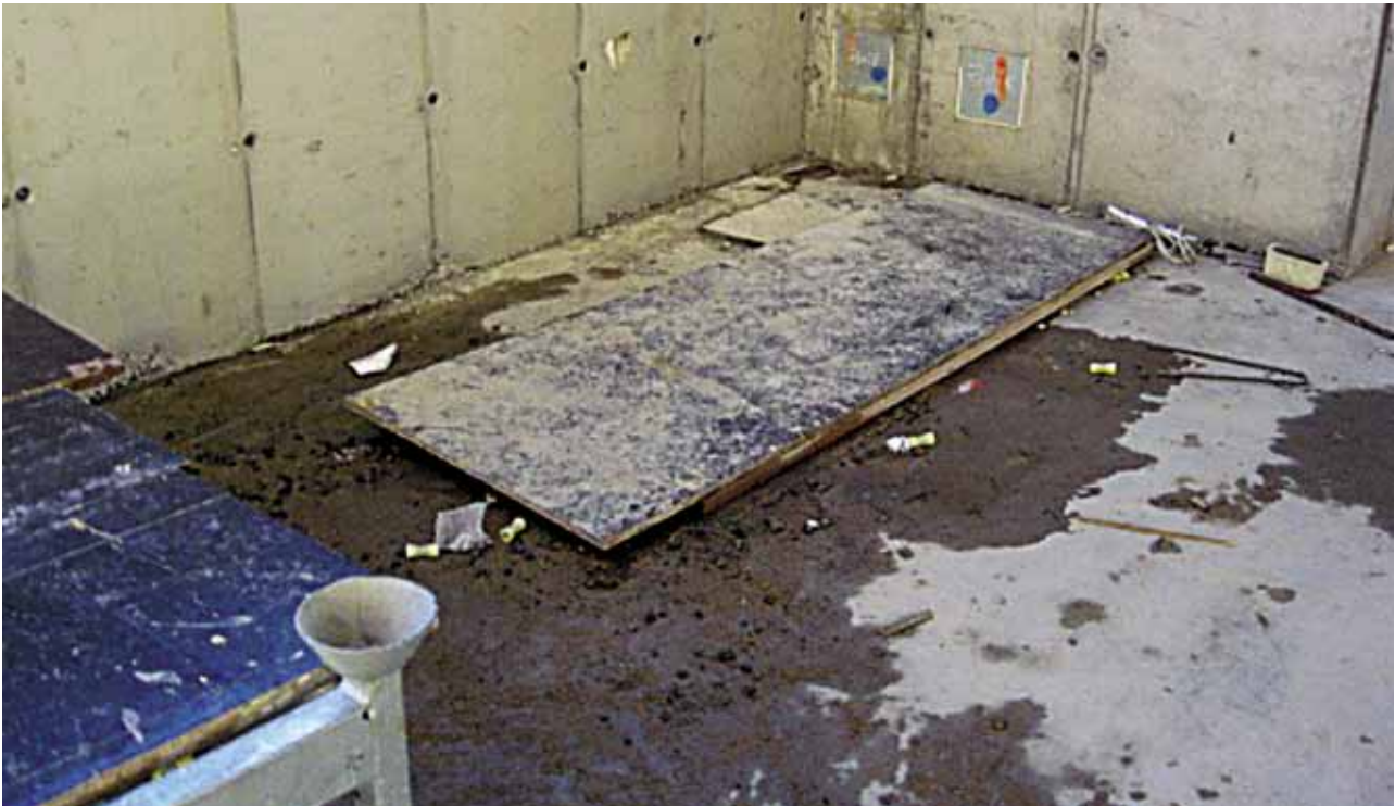
Kuva 1. Tapaturman aiheuttanut suojakansi.
