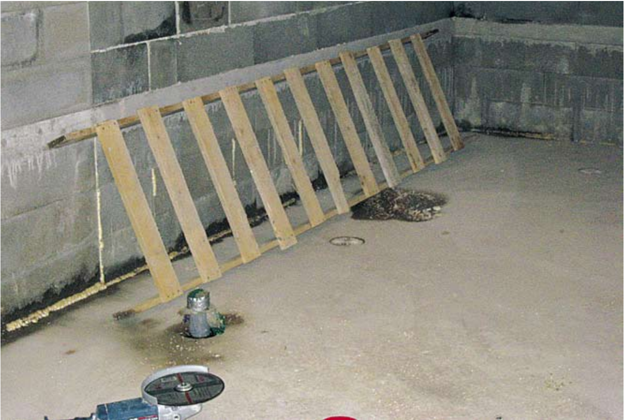
Kuva 2. Työntekijöiden tekemät puiset tikapuut, joilta NN ilmeisesti putosi.
