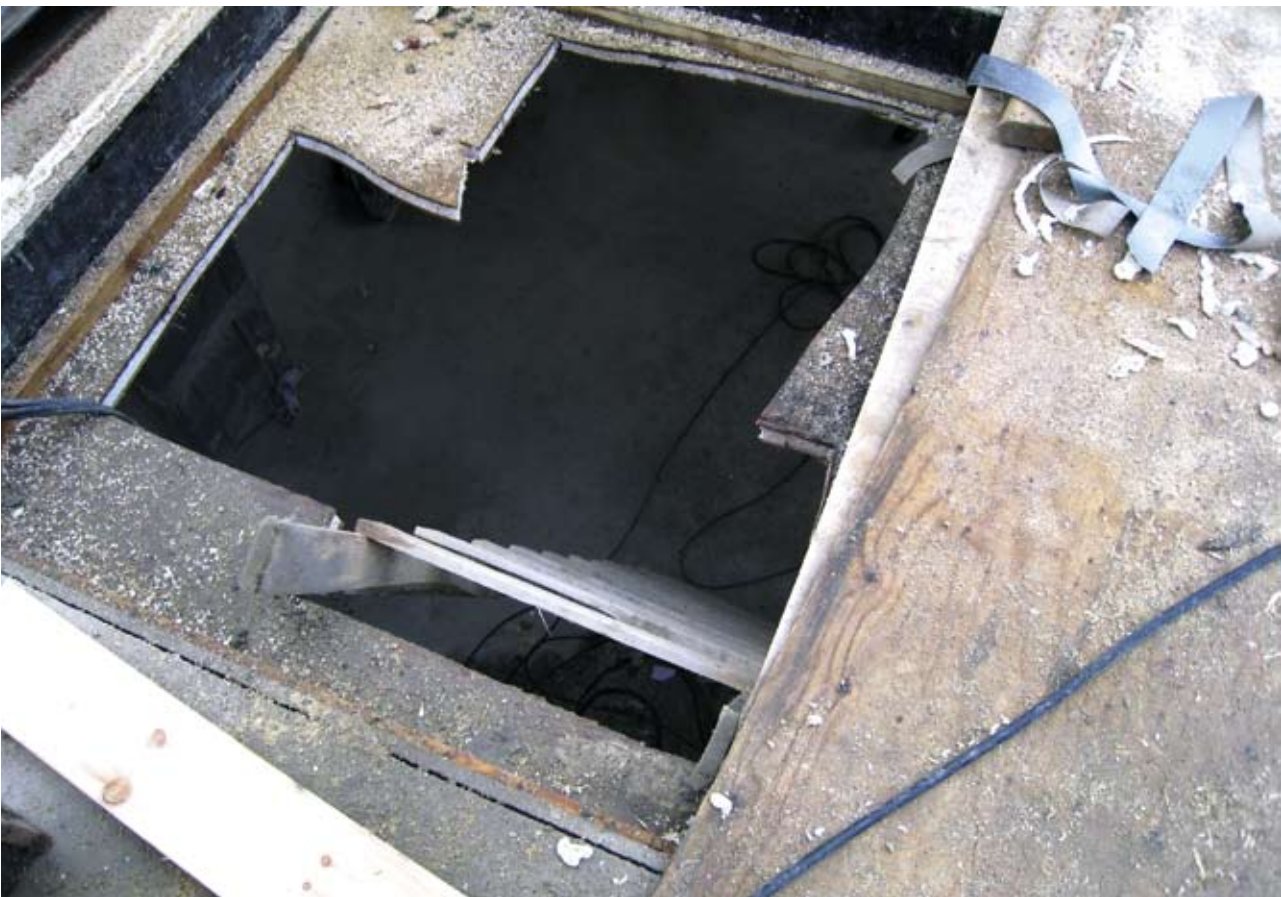
Kuva 3. Aukko ja tikapuut toisesta kerroksesta kuvattuna. Kun käytetään nojatikkaita, tulisi nojatikkaiden ulottua metrin tason yläpuolelle.
