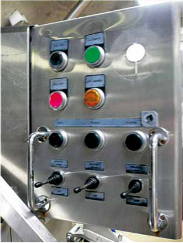
Kuva 1. Kuvassa ohjauspaneeli, jossa on ”joystick-malliset” käynnistyskytkimet. Häätäpysäytin on irrotettu.
