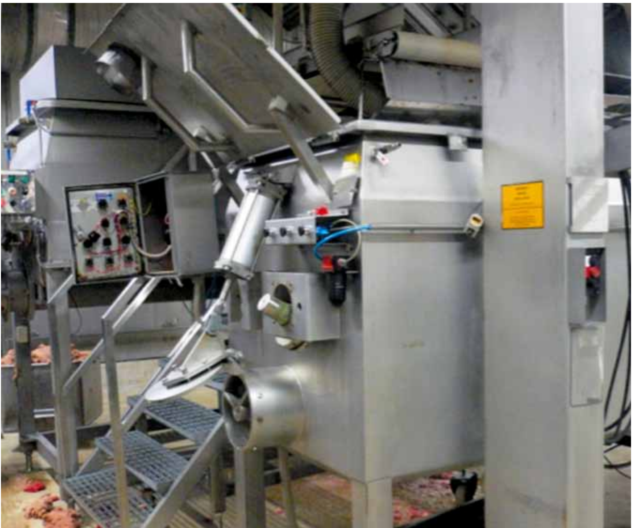
Yleiskuva sekoittimesta. Vasemmalla ylhäällä näkyy luukun läpivienti, jota oltiin tekemässä. Vasemmalta nousevat portaat työtasolle, josta pääsee siiloon.
