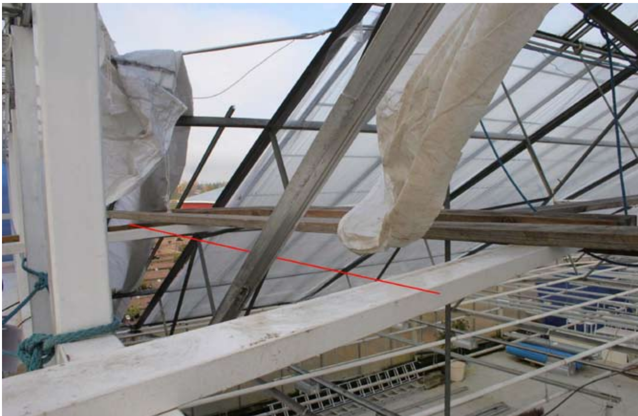
Kuva 2. Työskentelypaikka katon rajassa. Katkennut lankku oli etummaisena valkoisten lankkujen päällä. Punainen viiva kuvaa katkenneen lankun mahdollista paikkaa.
