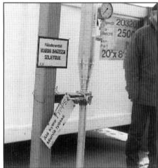
Kuva 1. Venttiili ja lähtevä typpiinjia, varoitustaulu.
