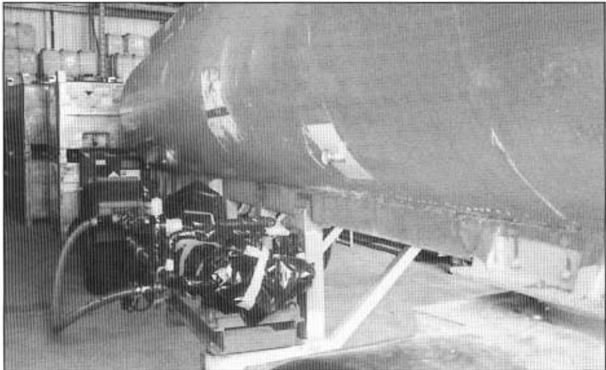
Kuva 4. Hiekkapuhallettava säiliö. Ulkona työtapaturman sattuessa, ks. piirros, kohta 1.
