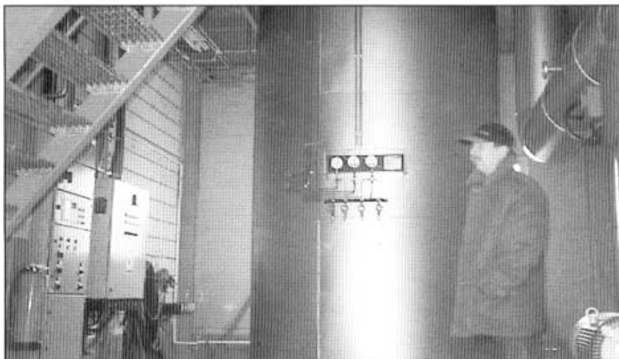
Kuva 6. Kattilalaitos. Valvontatauluja, huoltokohte oikealla etualalla, kuvan ulkopuolella.
