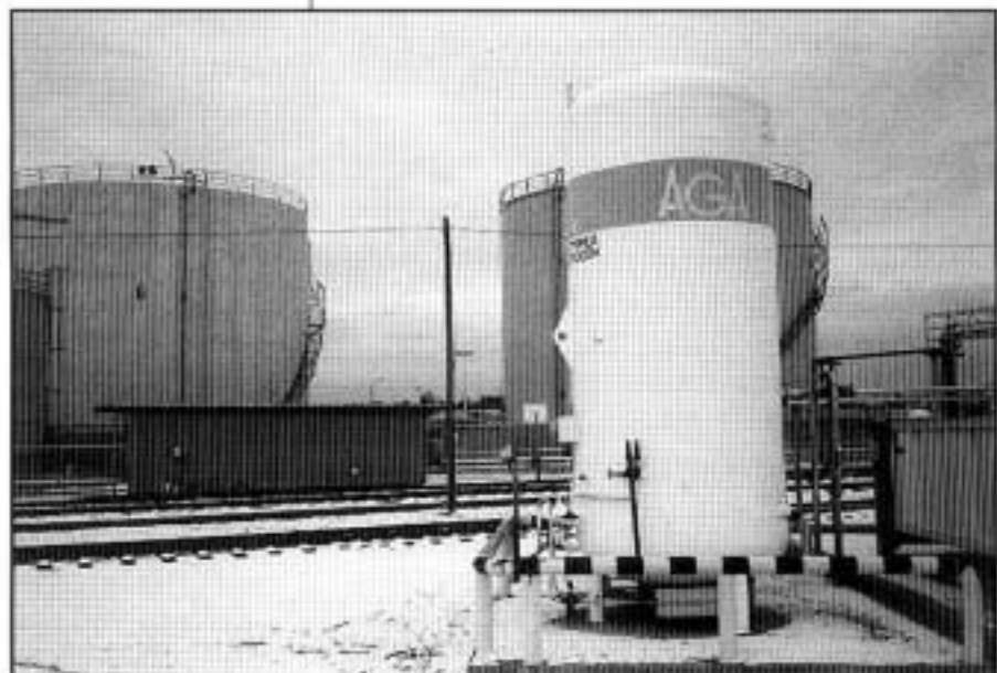
Kuva 2. Typpisäiliö, radan takana kompressorihuone.
