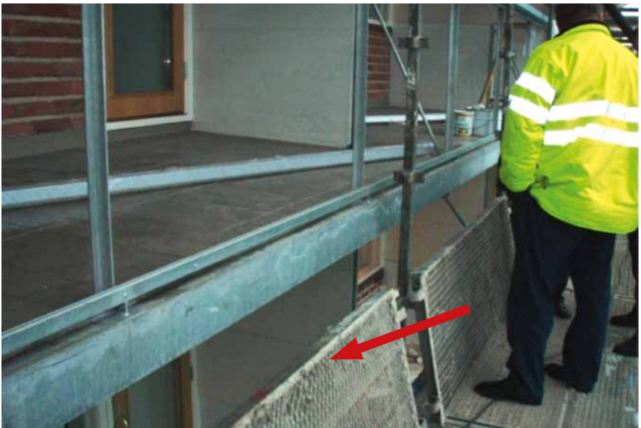
Kuva 2. Kuvan keskellä on parveke ja sen alapuolella suojakaiteena toiminut lisäisivuteline (nuoli), joka oli poistettu tapaturmahetkellä. NN putosi parvekkeen ja poistetun lisäisivutelineen välisestä 0,75 metrin korkuisesta aukosta alla olleelle parvekkeelle.
