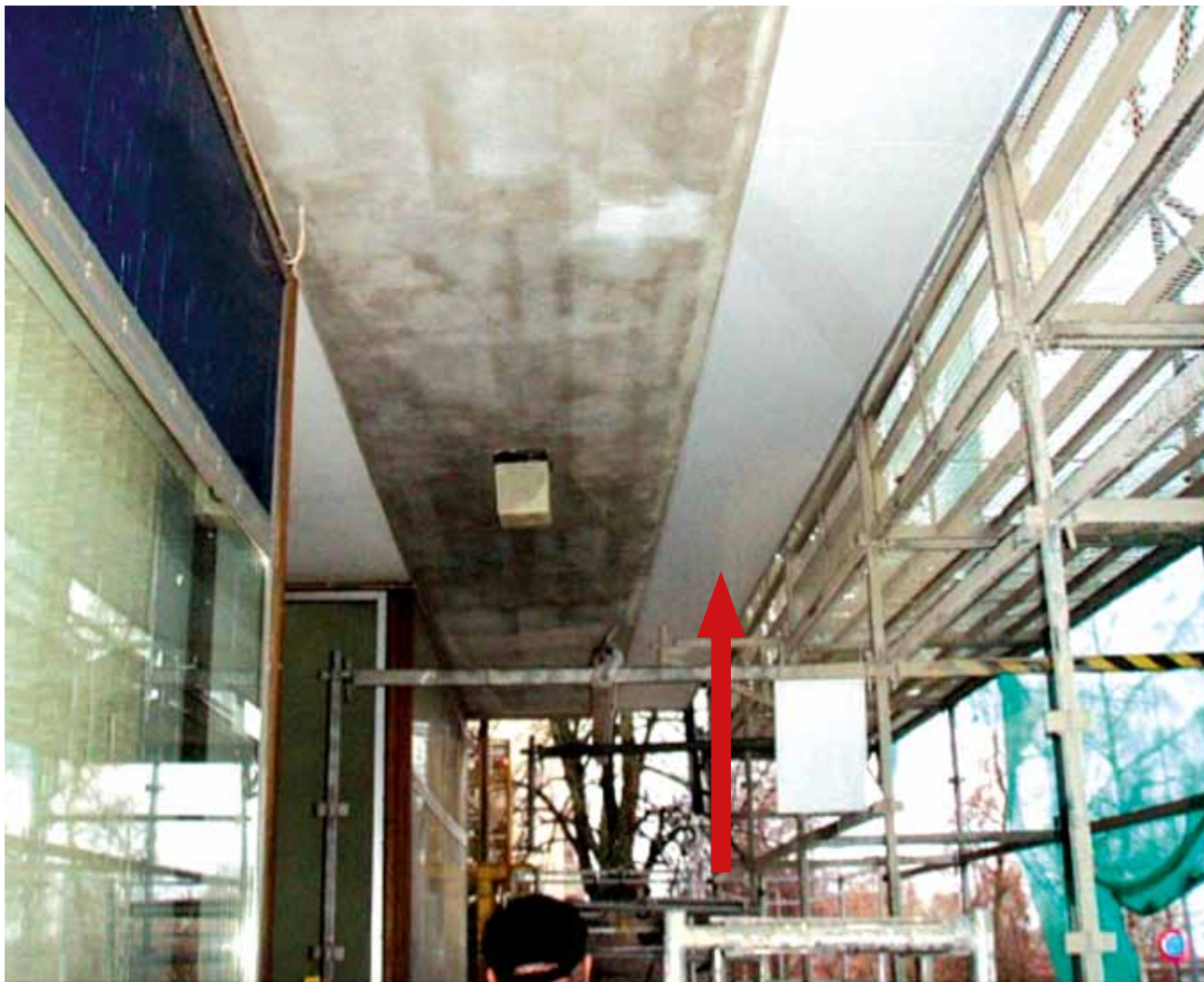
Kuva 1. Kuva saneeratun parvekkeen alapuolelta. Nuoli osoittaa parvekkeeseen liitettyä levennysosaa.
