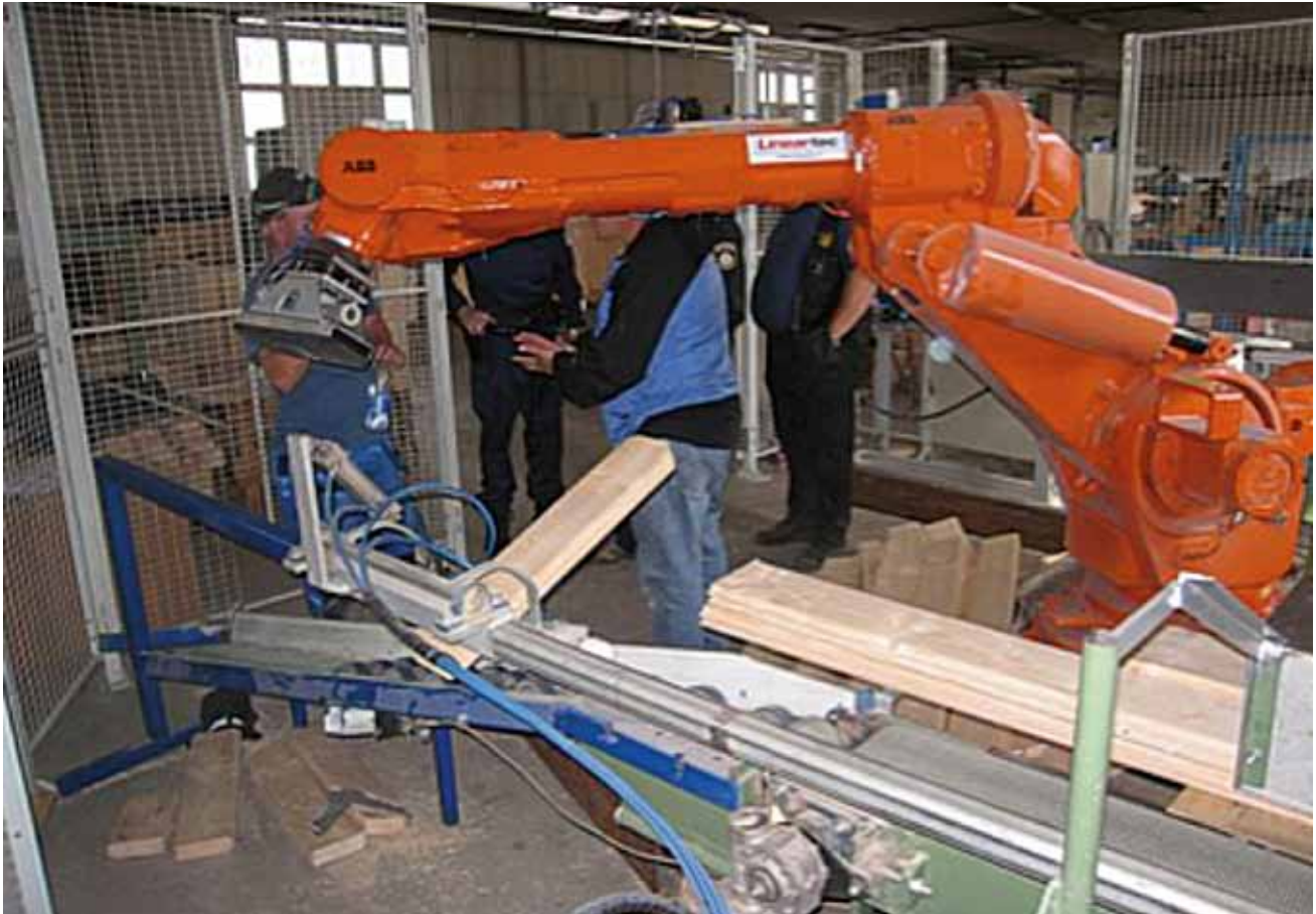
Kuva 3. NN oli yrittänyt vääntää poistokuljettimen päätyvastetta kuvan keskellä olevalla lankunpätkällä.
