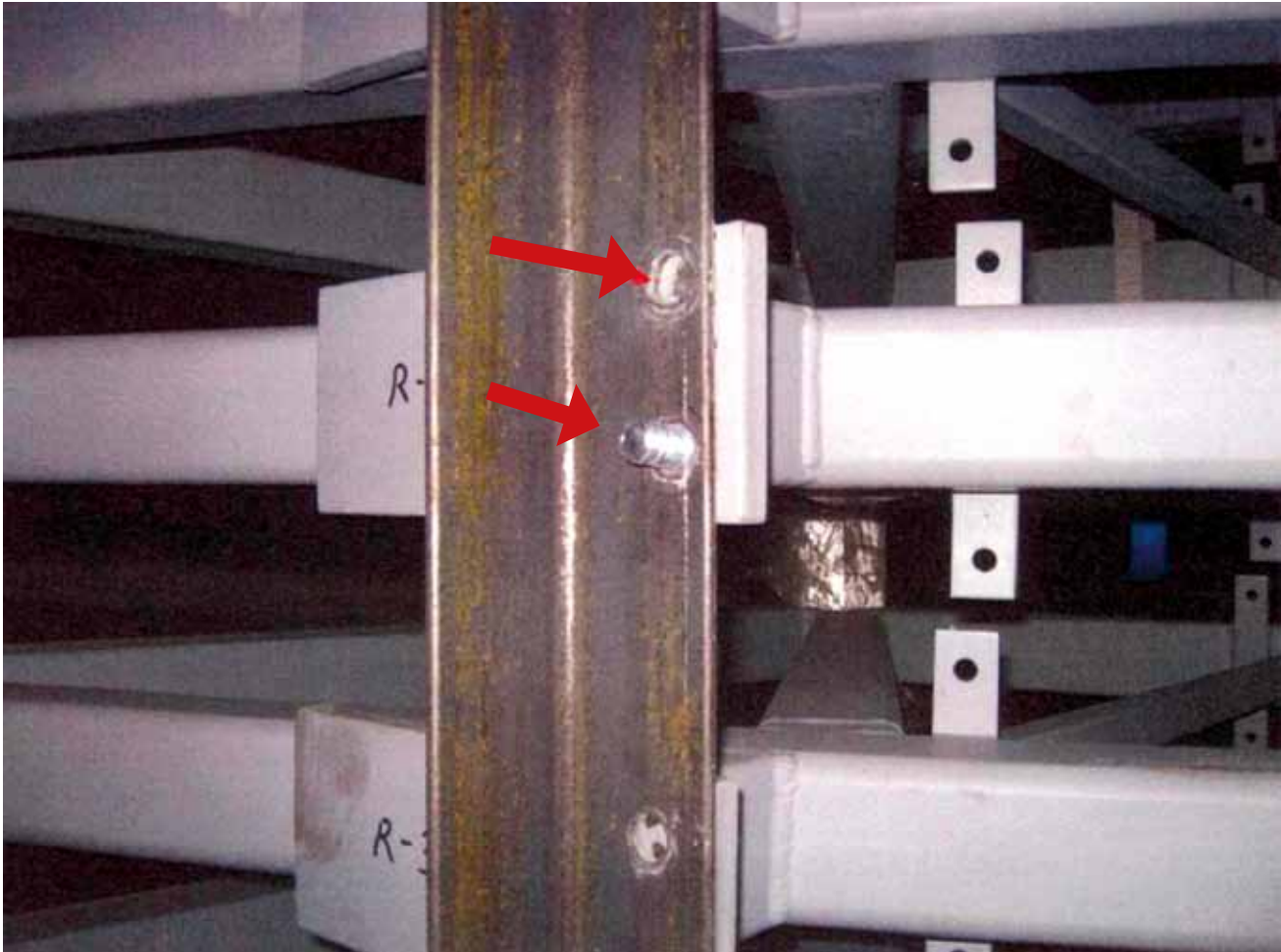
Kuva 3. Kulmarauta oli kiinnitetty jalkarautaan kahdella pultilla, joista toisen NN oli ehtinyt irrottaa ennen tapaturmaa.
