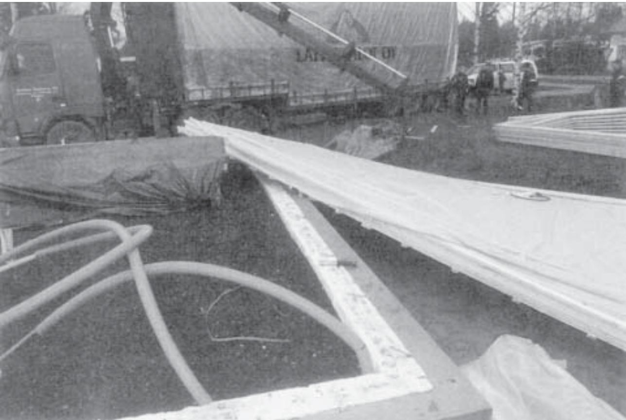
Kuva 2. Puristumiskohta elementin ja sokkelin väliin.
