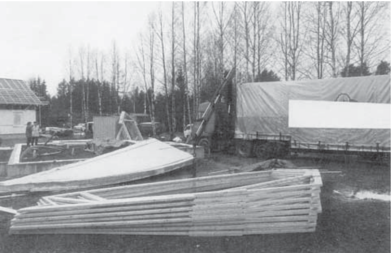
Kuva 1. Keskellä vasemmalla sokkeli ja nostossa pudonnut seinäelementti.
