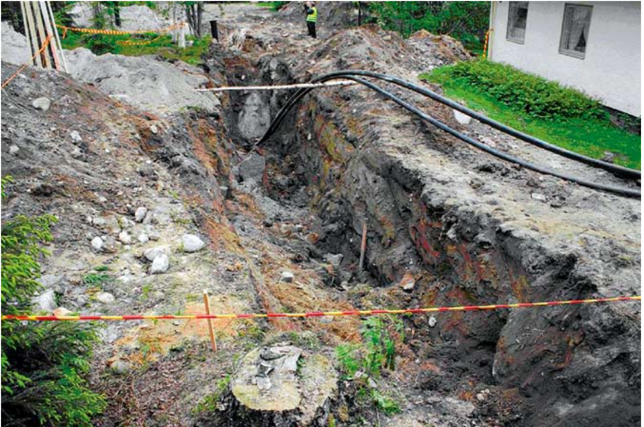
Kuva 2. Yleiskuva tapaturmapaikasta. Kuvassa sortumakohta.
