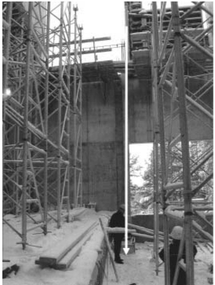
Kuva 4. Työtasojen väliin jäi pilasterin johdosta noin 84 cm:n levyinen aukko, joka peitettiin vanerilevyillä. Tähän kohtaan jäi suojakaitteeseen saman levyinen aukko. Nuoli osoittaa NN:n putoamislinjaa.
