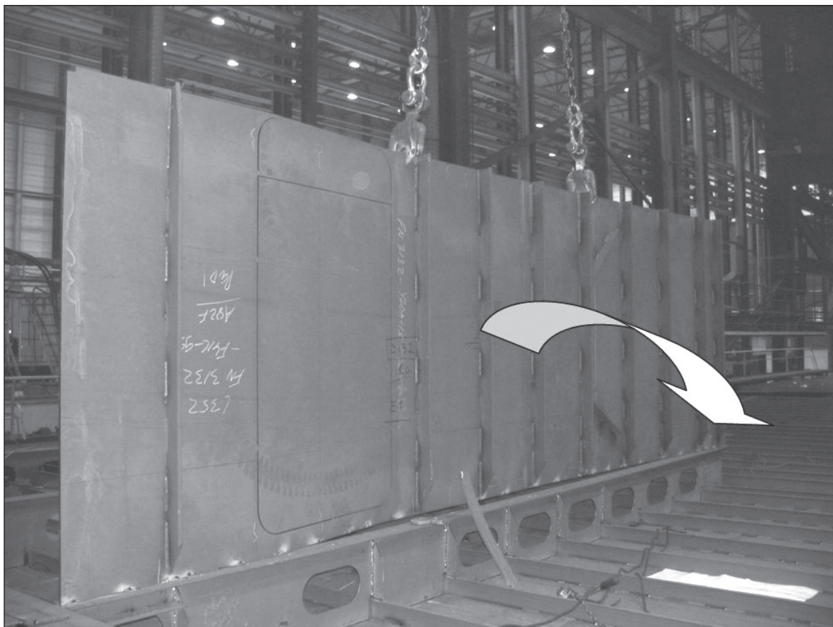
Kuva 2. Elementti kaatui nuolen osoittamaan suuntaan. Kuva on otettu tapahtuman jälkeen. Tapahtumahetkellä nosturi oli jo irrotettu laipiosta.
