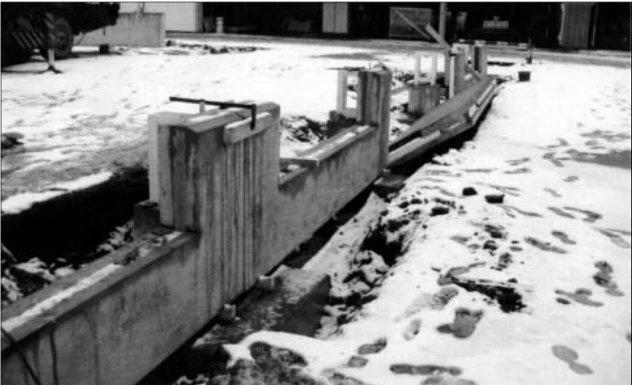
Kuva 4. Ruuvipuristin, kaatunut elementti.
