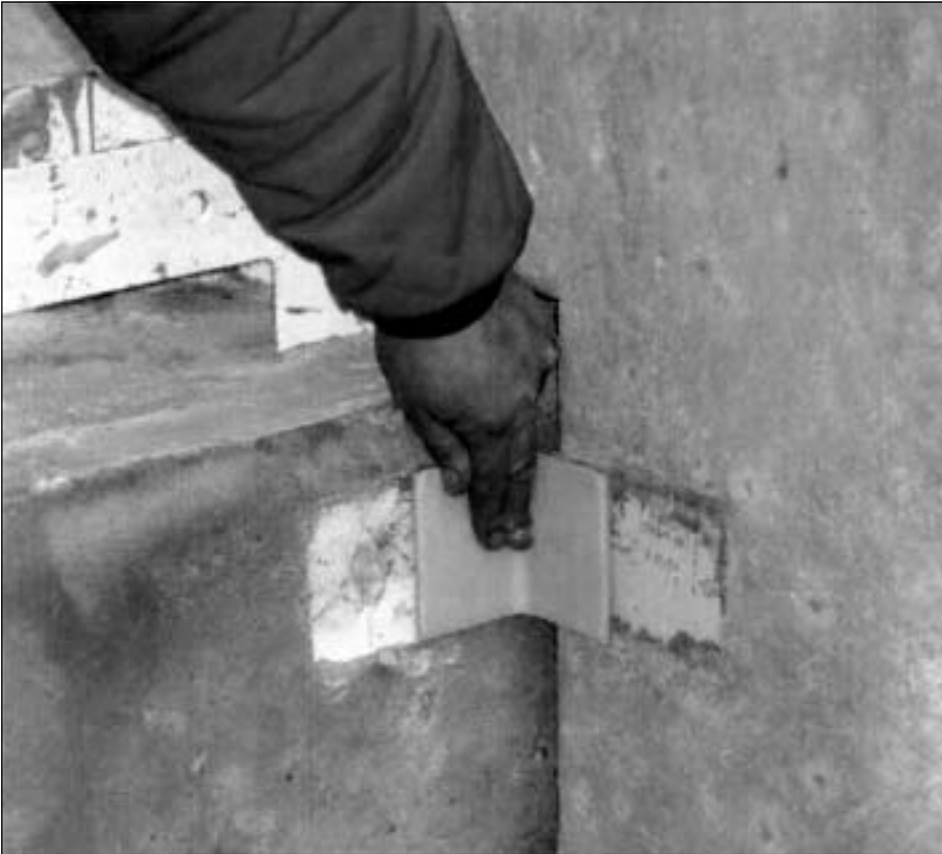
Kuva 1. Elementit oli tarkoitus kiinnittää anturaan hitsaamalla kulmarautaa teräs-asennuspaloihin. (Alunperin tarkoitukseen varatut kulmaraudat olivat alimitoitettut).
