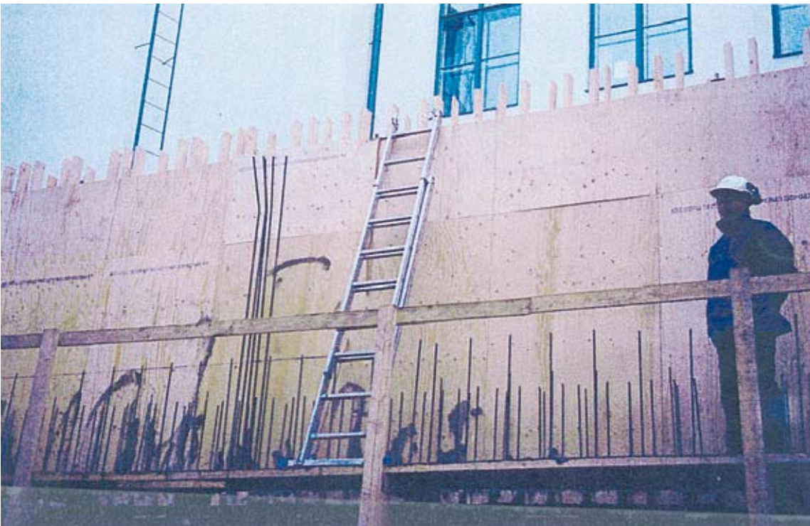
Kuva 2. Kuvan alumiinitikkaat on asetettu samalla tavalla ja suunnilleen samalle kohtaa telineille, kuten NN oli tehnyt tapahtumapäivänä. Betoniletkun kiinnitysnauru tikkaan vasemmalla puolella.
