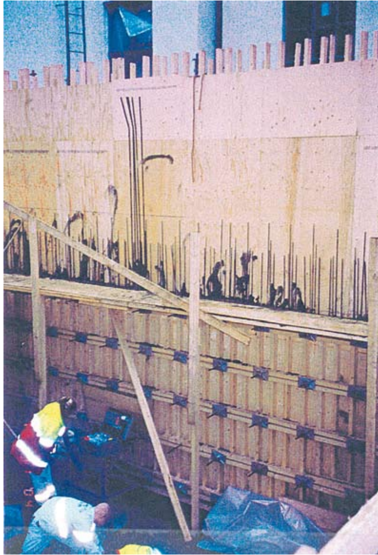
Kuva 3. Kuva heti tapahtuman jälkeen. Muottilaudoituksen yläreunassa näkyy aikaisemmin mainittu köysi. Telineitä oli jo alettu purkaa, kun tapaturma sattui. Tapahtumakohdalla on telineen kaide toisesta päästä irti. Edellisestä juoksuvälistä oli jo kaide purettu.
