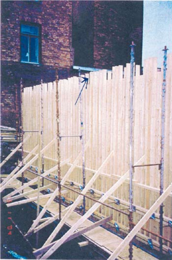
Kuva 1. Kuva on otettu studion seinälaudoituksen ulkopuolelta. Betoniauton syöttöletku tuotiin kyseisen laudoituksen yli poiketen alkuperäisestä suunnitelmasta.
