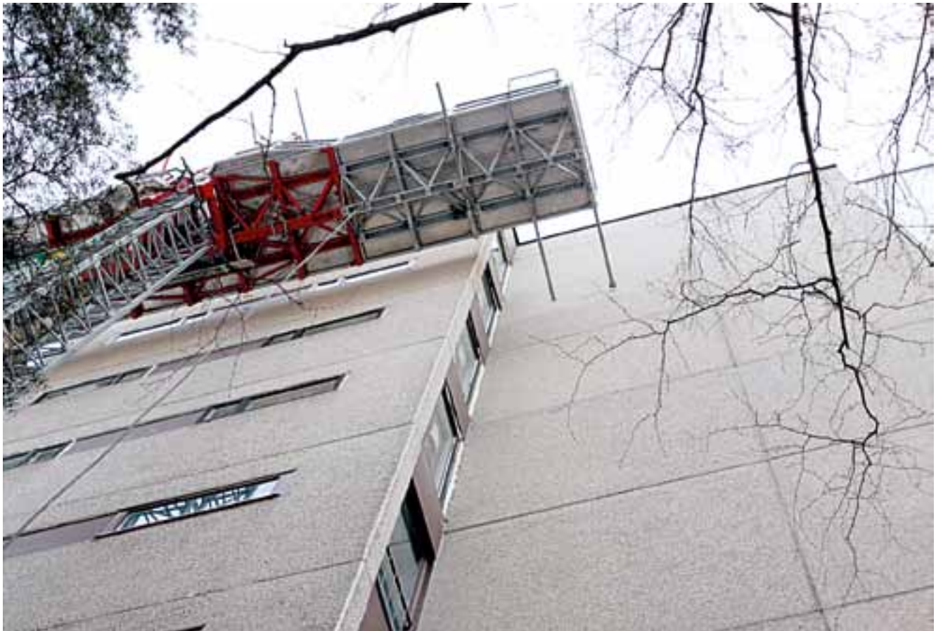
Kuva 8. Mastonostimen maston kallistuminen esti työtason nostamisen ylös, sillä yksi ulokeputki naarmutti seinärakenteita noston aikana.
