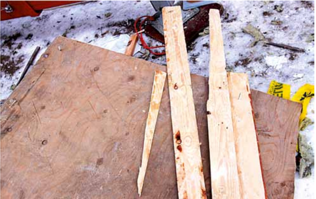
Kuva 7. Vanerinen työtaso oli kiinnitetty lautoihin muutamalla ruuvilla. Kolmasosa vanerilevyistä toimi ulokkeena.
