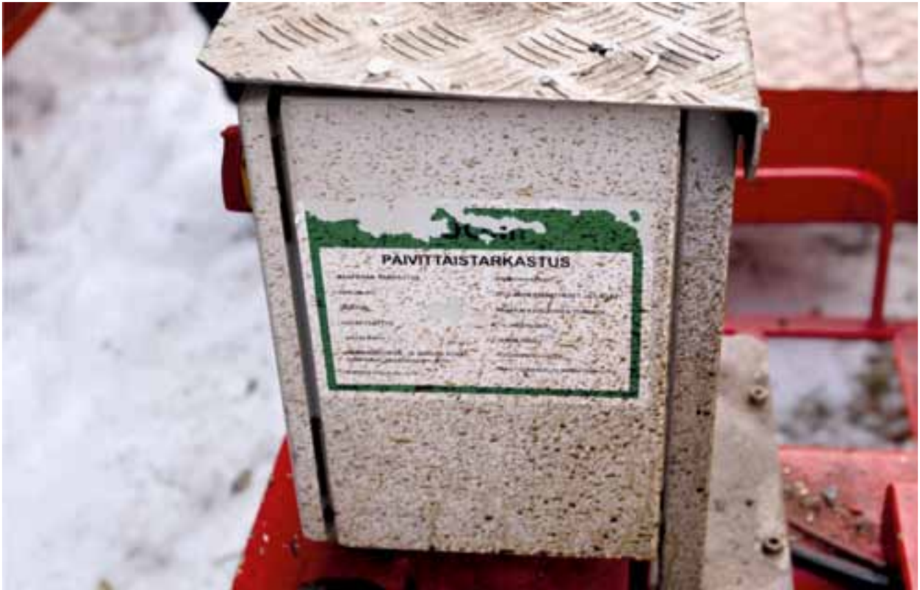
Kuva 9. Mastolavan runkorakenteeseen oli liimattu tarra, jossa oli muistilista päivittäistarkastuksen laajuudesta. Tarra ja siinä oleva teksti oli kulunut lähes lukukelvottomaksi.
