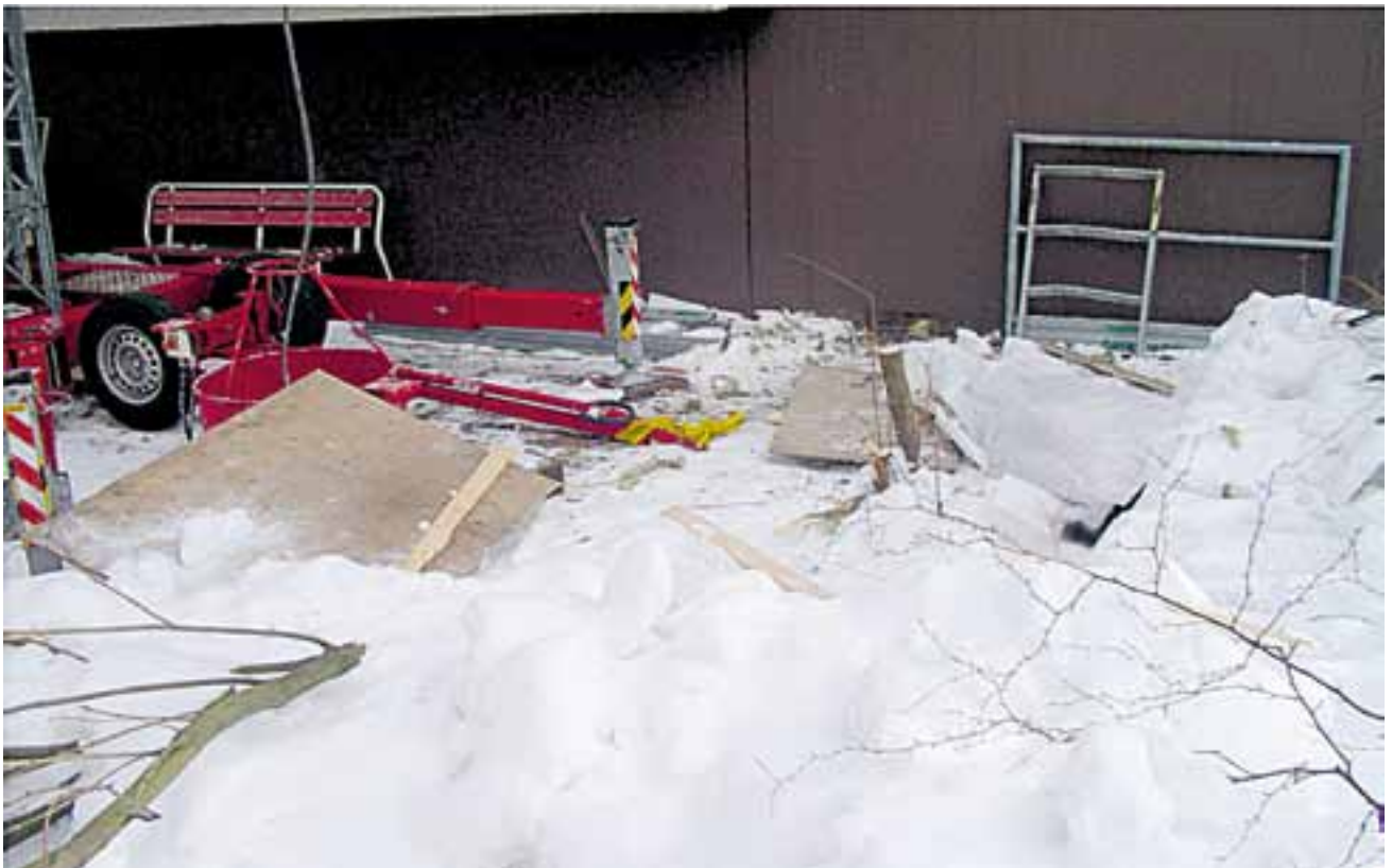
Kuva 4. Mastolavan tukijalat olivat painuneet lumeen, jonka seurauksena mastolava oli kallistunut seinää kohti.
