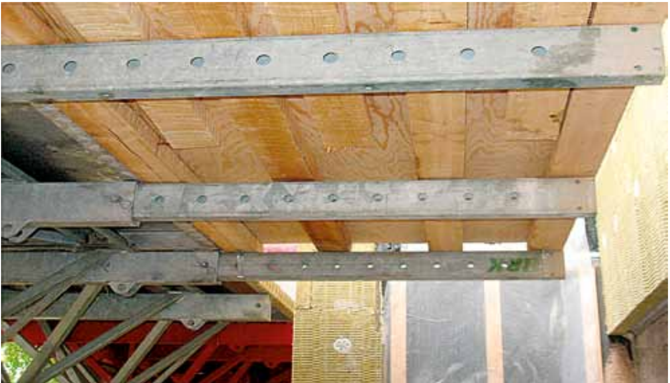
Kuva 6. Lähimpänä ranskalaista parvekettä oleva ulokeputki oli työnnetty sisään, joten työtaso toimi ulokkeena. Riittämättömästi kiinnitetty työtaso kippasi ja putosi alas.
