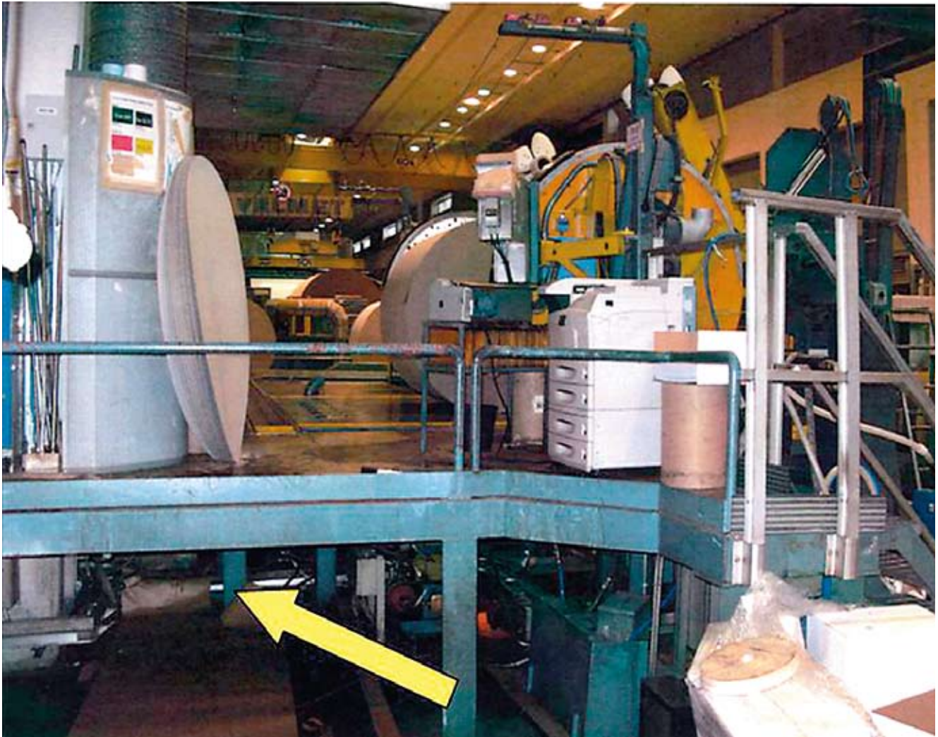
Kuva 5. NN meni koneen alle viimeistelläkseen korjaustyöt. Pääsyä vaara-alueelle ei ollut mitenkään estetty.
