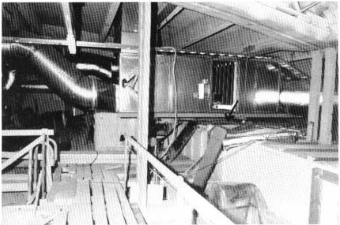
Putoamiskohta ilmastointikanavassa merkitty nuolella. Poistoilmakoje vasemmalla. Kulutie kuvan keskellä.
