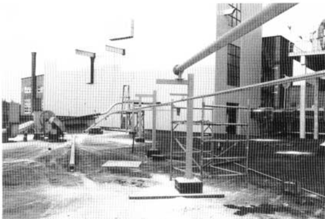
Kuva 1. Suolansiirtoputki tapahtuman jälkeen. Oikealla teline, jolla NN oli seissyt, vasemmalla maahan pudonnut putkiston osa ja paikaltaan siirtynyt putki.
