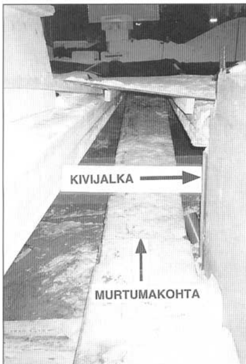
Kuva1. Murtunut ja alaspudonnut ontelolaatta.
