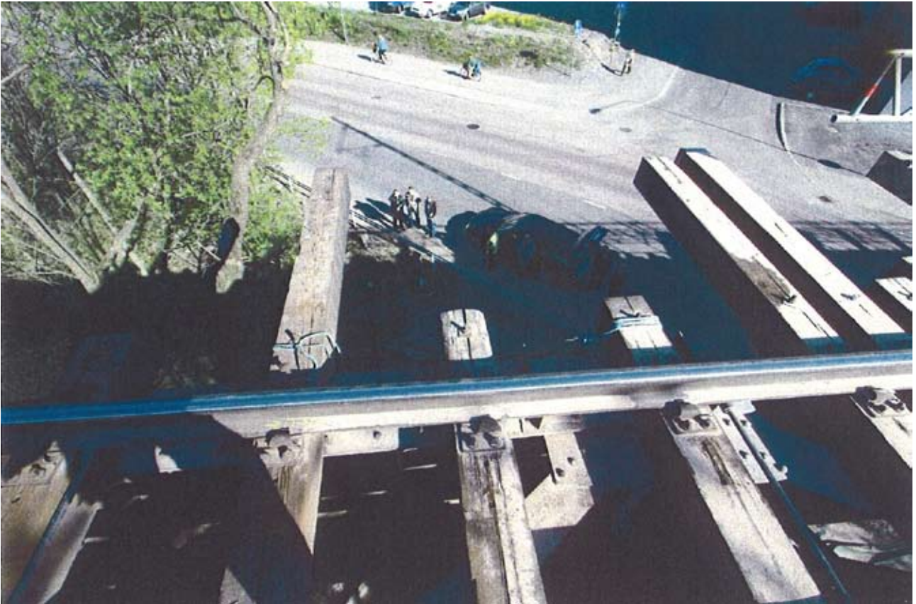
Kuva 3. Putoamiskohdalla ei ollut kaidetta, työtasoa tai apulavaa. Kuvan kohdalta joka toinen ratapölkky on poistettu. Ratapölkkyjen väliin jää n. 50 cm aukko. Pressu ei näy kuvassa.
