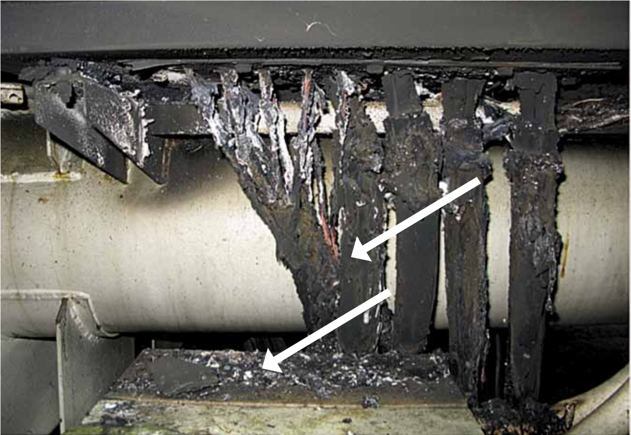
Kuva 3. Ylikuumentuneen kondensaattorin sytyttämät sähkökeskukseen menevät kaapelit. Alanuoli osoittaa syttymislähteenä toimintua kondensaattoria ja ylempi nuoli lämmön vaikutuksesta syttyneitä kaapeleita
