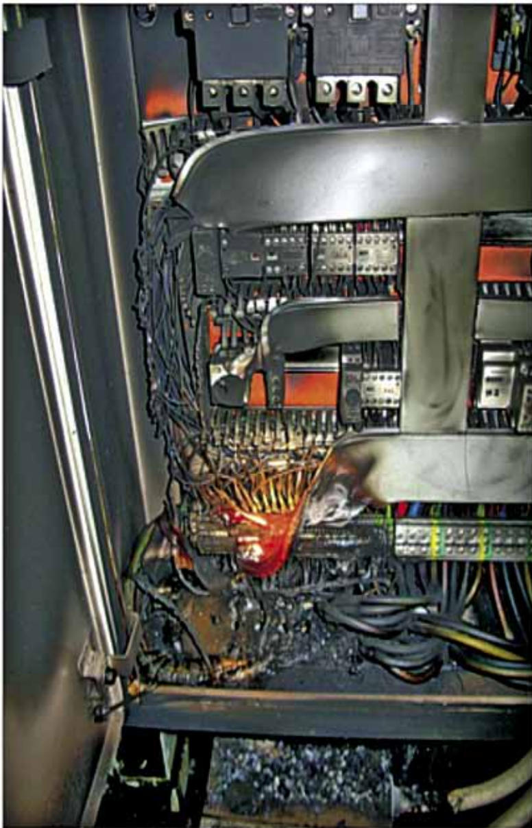
Kuva 4. Palon aiheuttamia vaurioita sähkökeskuk- sen kaapeleiden läpivienneissä ja johdotuksissa keskuksen sisällä
