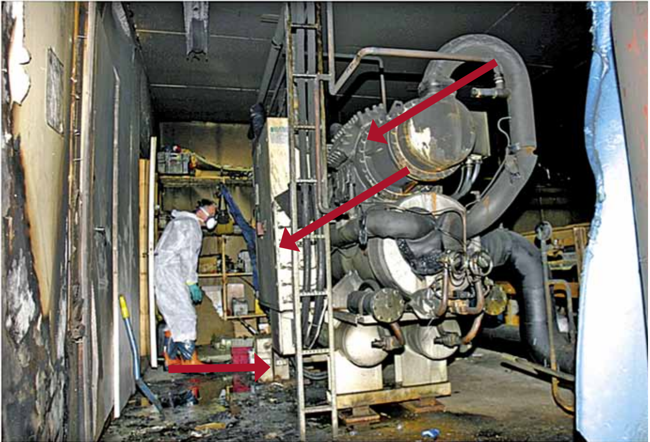
Kuva 5. Kuvassa on ylikuumentunut kondensaattori sähkökeskuksen alapuolella (alanuoli), sähkökeskus (keskinuoli) ja jäädytyslaitteen kompressori (ylänuoli).
