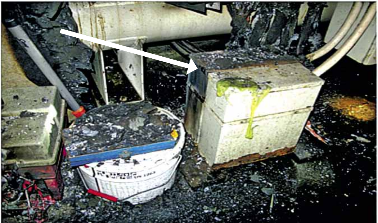
Ylikuumentunut kondensaattori (nuoli).
