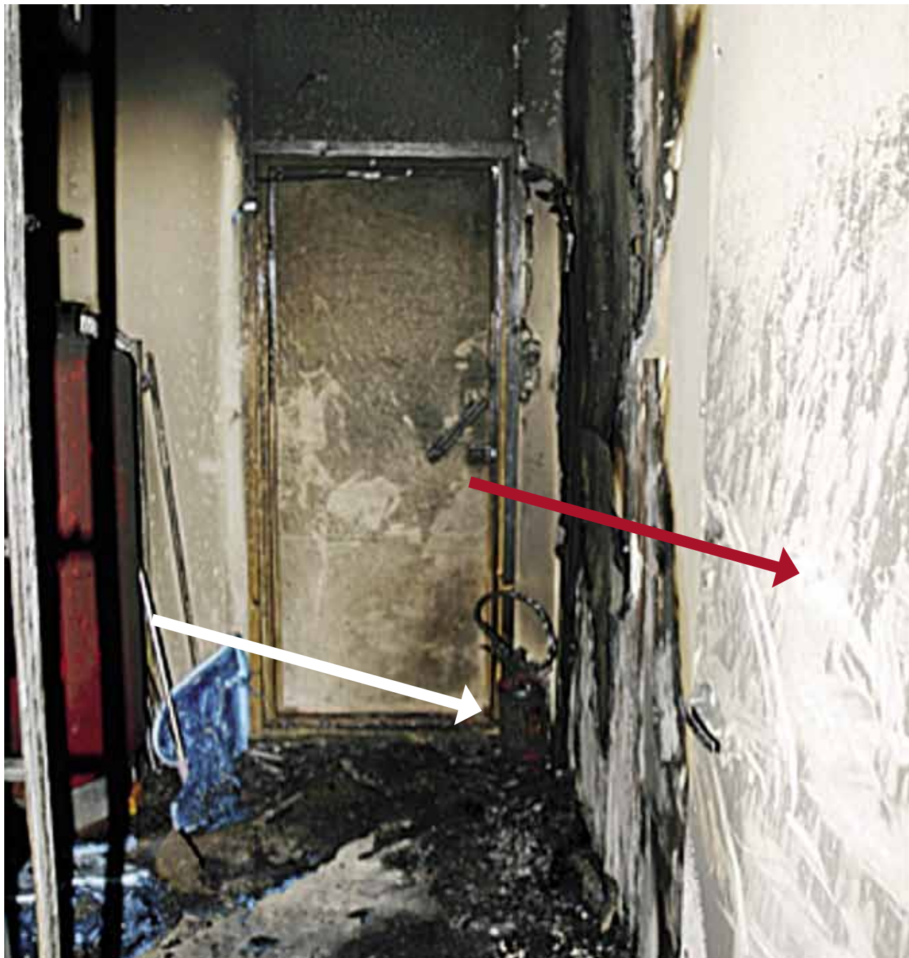
Kuva 1. Keskellä kuvaa ulko-ovi, josta NN yritti ensin paeta ulos. Ulko-oven oikeassa reunassa sammutin (nuoli). Kuvan oikeassa reunassa ovi (nuoli), joka johtaa lepo/ruokailutilaan, jossa NN oli lepäämässä.
