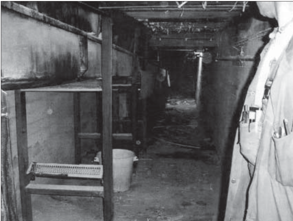
Kuva 1. Kuljetintunneli. Tapaturmapaikka kuvan vasemmassa laidassa.
