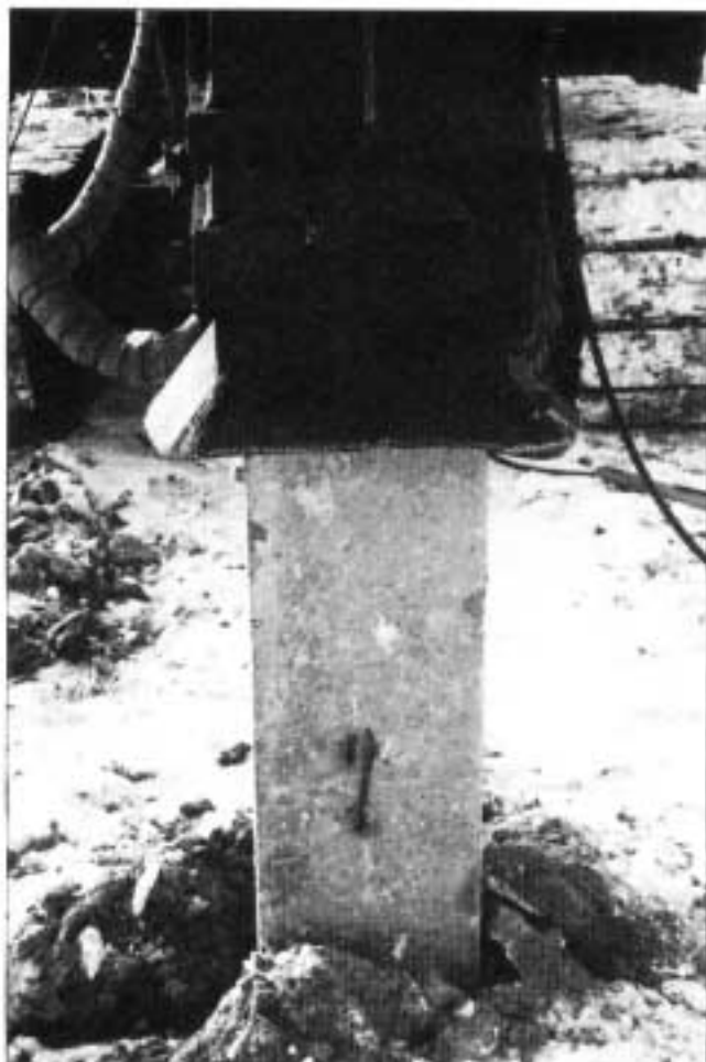
Kuva3 : Juntattu paalu, katkennut käsittelylenkki.
