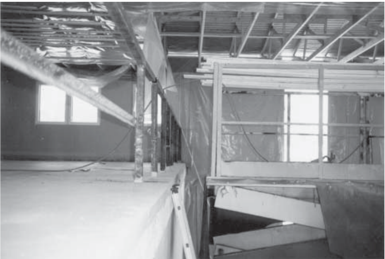
Kuva 2. Nostimen työtason kaiteille varastoitua puutavaraa.
