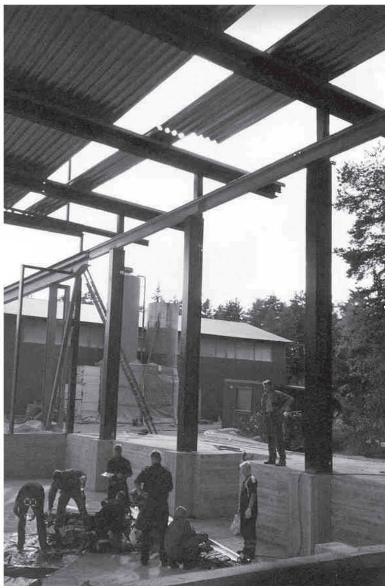
Kuva 1. Yleiskuva tapahtumapaikalta. NN astui rakenteilla olevalla katolla kiinnittämättömälle kattopellille ja putosi betonilattialle.
