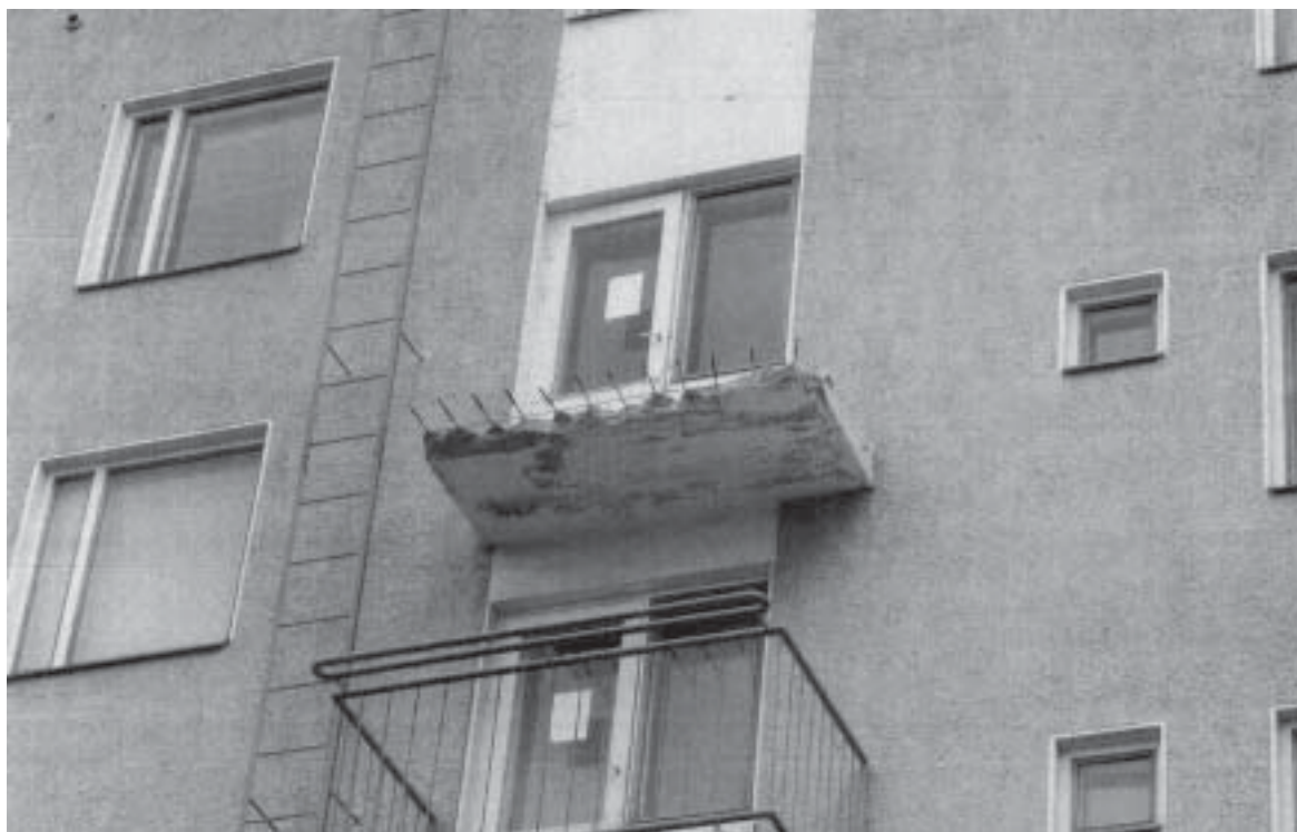
Kuva 2. Parvekelaatan piikattu etureuna, josta parvekekehikon kiinnikkeet murtuivat.
