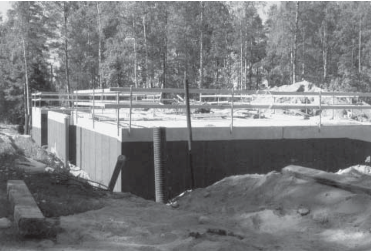
Kuva 1. Yleiskuva. Kaatunut elementti vasemmalla kulman takana.
