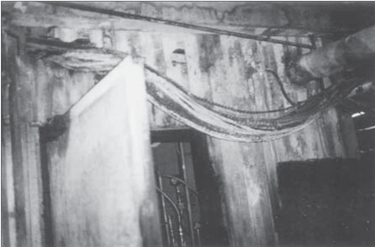
Kuva 3. Yleiskuva tulisoihdun aiheuttamista jäljistä. Oikeassa yläkulmassa näkyy osittain sulanut kaapelihyly.
