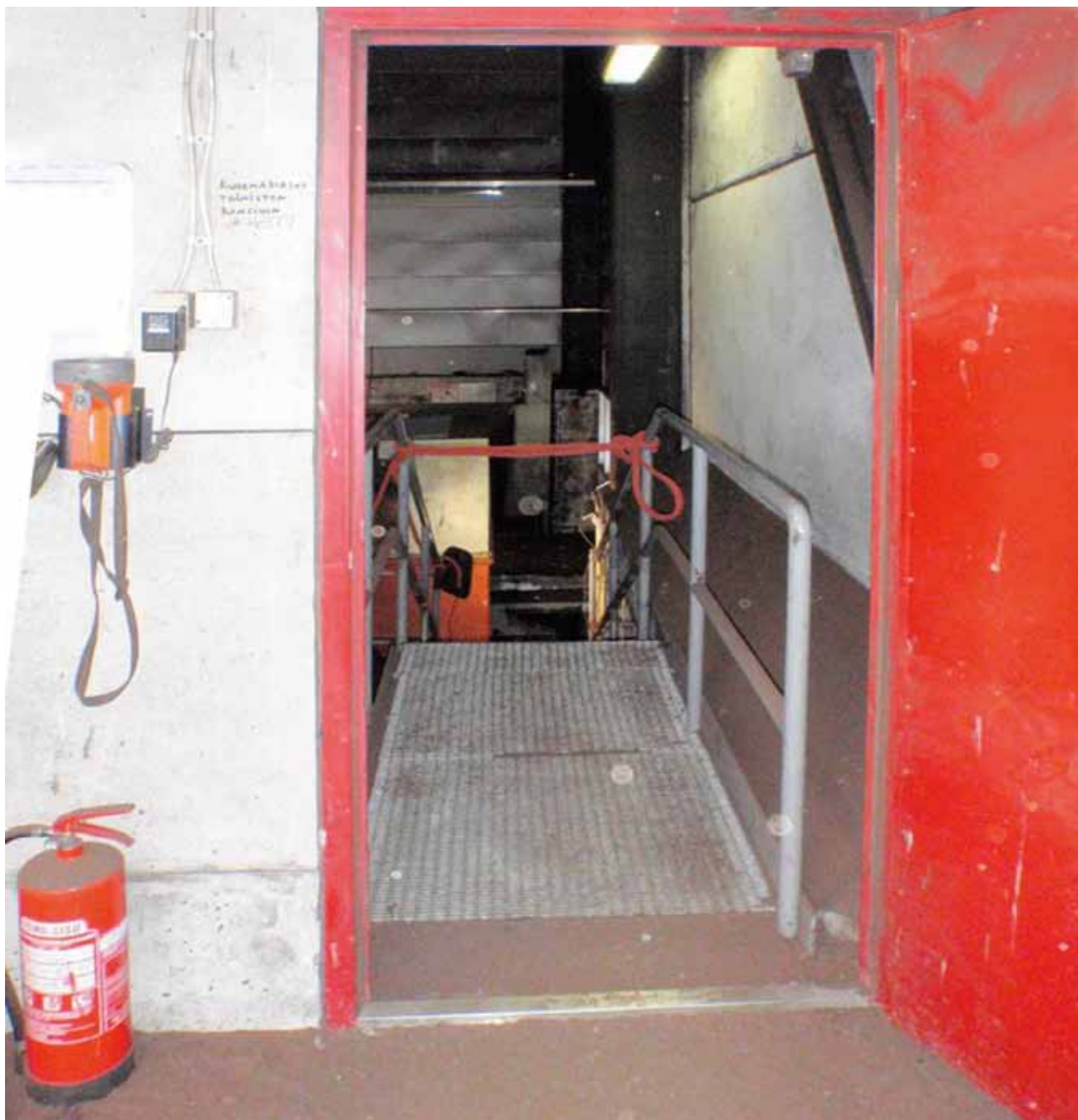
Kuva 1. Näkymä ovelta portaikkoon. Ovelta on n. kaksi metriä tasaista kävelysiltaa, jonka jälkeeen ritiläportaat laskevat lähes neljä metriä alaspäin ns. huoltotasolle. Kuvassa näkyvä köysi on asennettu tapaturman jälkeen
