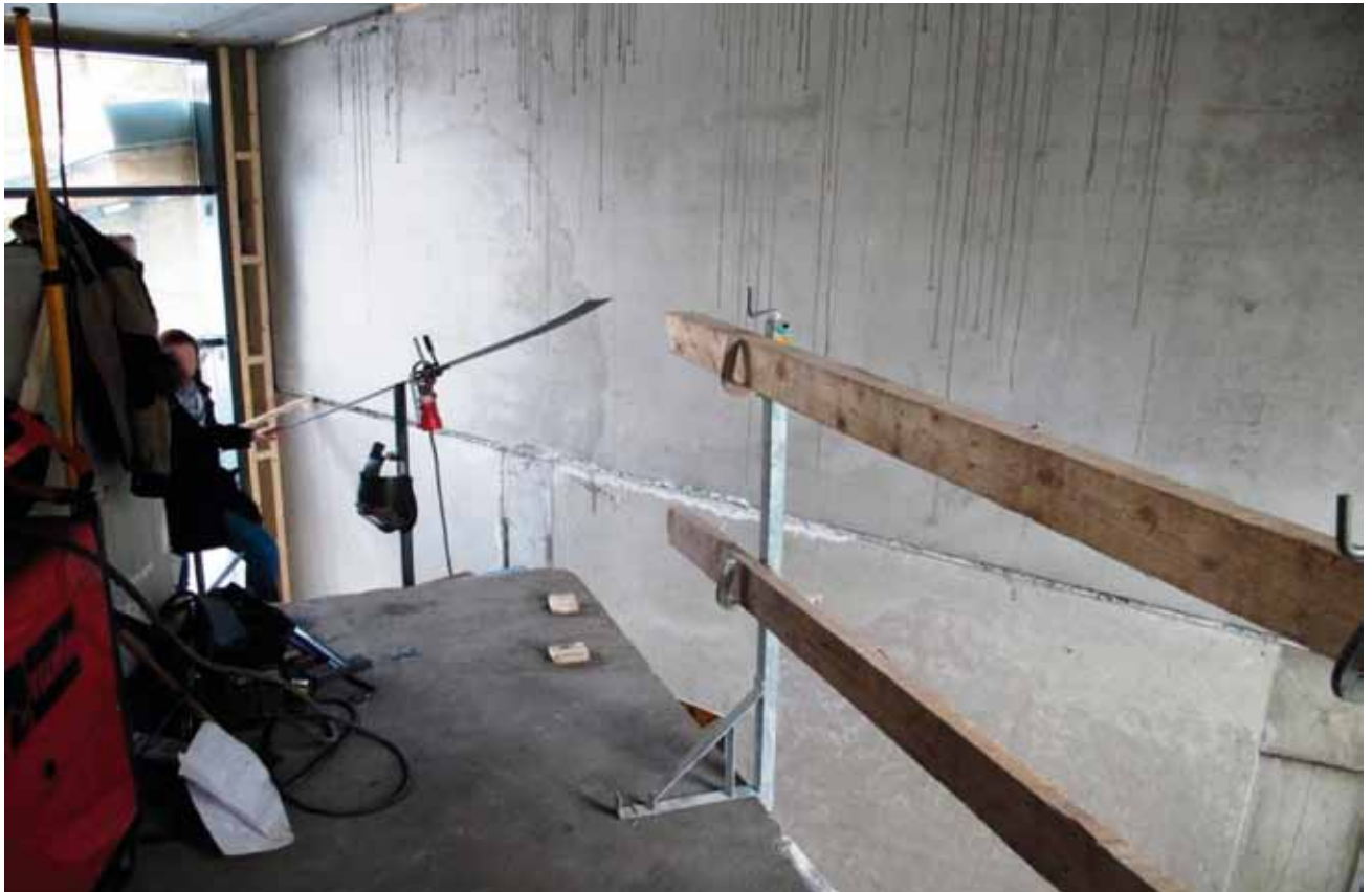
Kuva 2. Kuvan vasemmassa reunassa lattialla työvälineitä, joita jouduttiin väistämään. Tapaturman jälkeen putoamiskohtaan asennettiin oikeassa reunassa näkyvä tilapäinen suojakaide.
