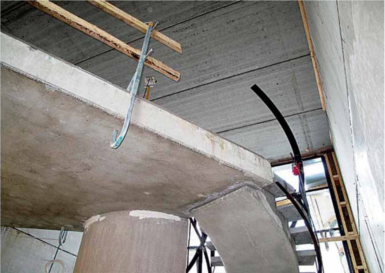
Kuva 1. Kuva on otettu toisen kerroksen betoniholvilta, kohdalta mihin NN putosi. Vasemmassa reunassa näkyvä suojakaide on asennettu heti tapaturman jälkeen.
