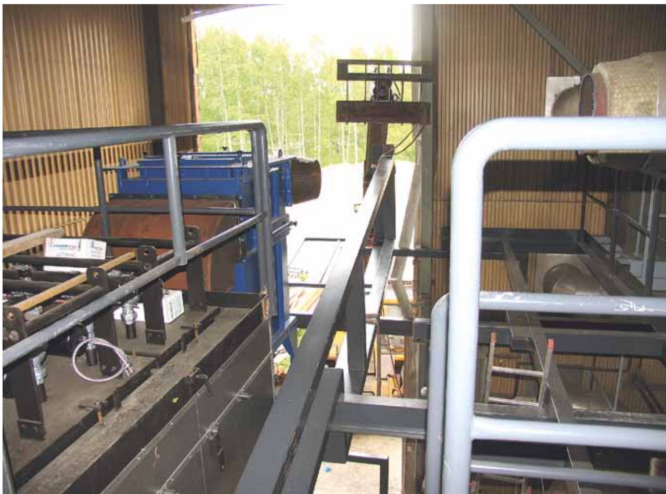
Kuva 1. Hoitotason kiepahtanut runko-osa. Kuvassa oikealla näkyy myös tikapuut, joita pitkin NN nousi hoitotason rungon päälle.
