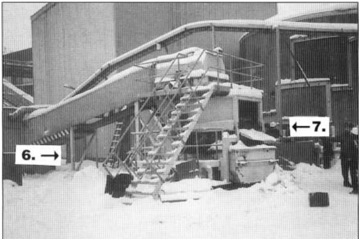
Kuva 4. 6. = ovi, josta päästään n. 5 m:n korkeudelle hoitotasolle ja kolakuljettimen (5.) turvakytkimelle, 7. = hihnakujuksen (4.) turvakytkin
