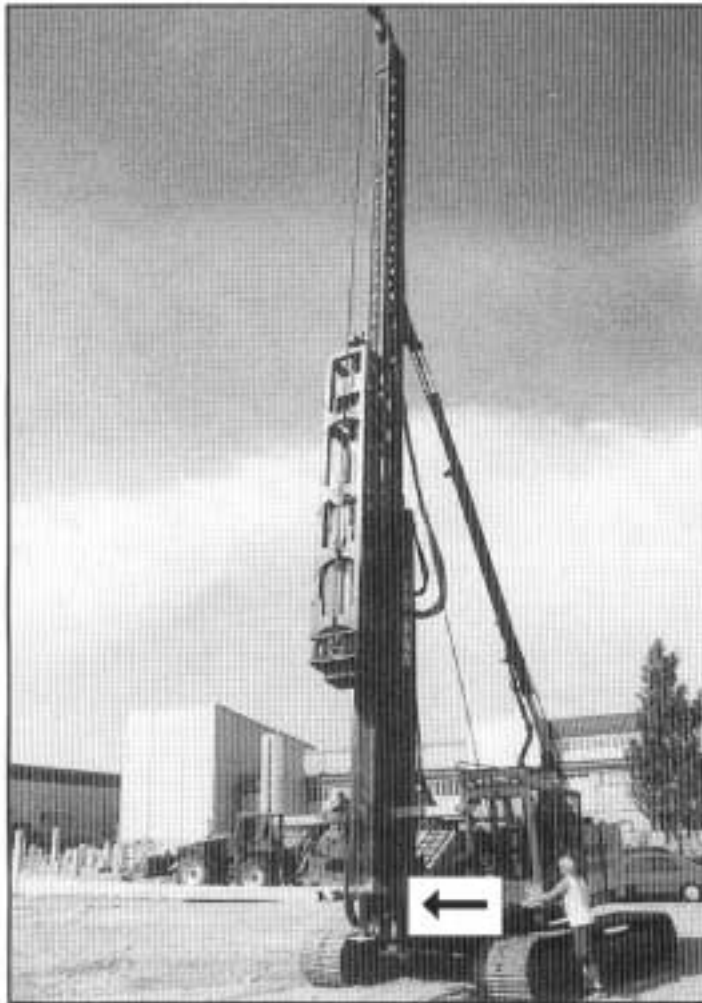
Kuva 1. Junttakonesylinterin alapää jossa mutteri, merkitty nuolella.
