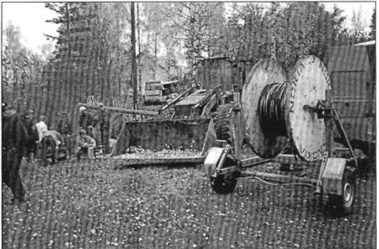
Kuvat 1 ja 2. Pylväs asennossa, johon kaato pysäytettiin. NN:n tuloreitti kaivurin kauhan suunnasta. Kuvassa 2 talon kohdalla NN:n työkohte, uusi pylväs.
